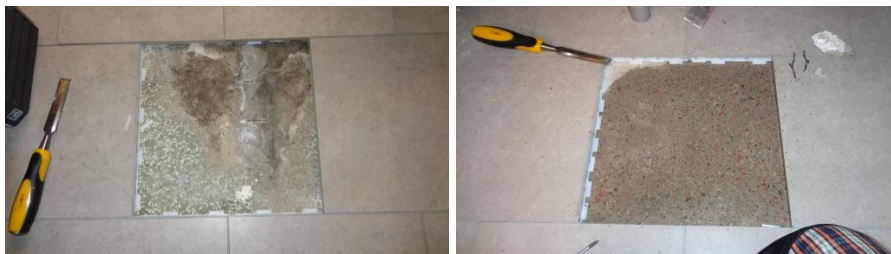
Kuvat 5 ja 6. Kellarikerroksessa lattian pintamateriaalina olevan ”uivan” keraamisen laatoituksen alapuolella betonirakenne oli märkä.
