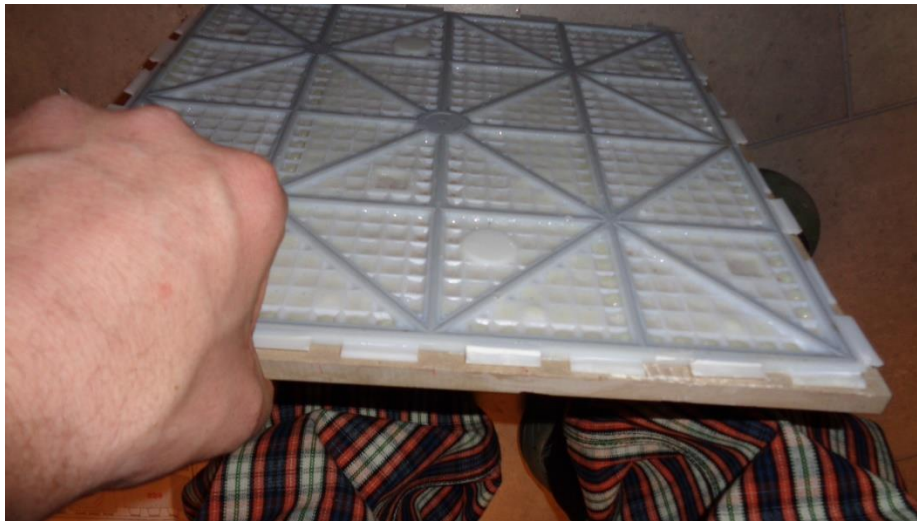
Kuva 1 Kellarikerroksen lattian pintamateriaalina käytetty ClipTile -laattaa.
