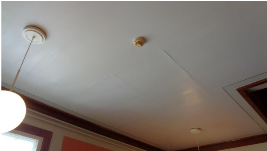
Kuva 11. Vuotojälki Mediateekin tiloihin johtavan portaikon katossa. Materiaalinäytteen perusteella materiaalissa heikko viite vauriosta.
