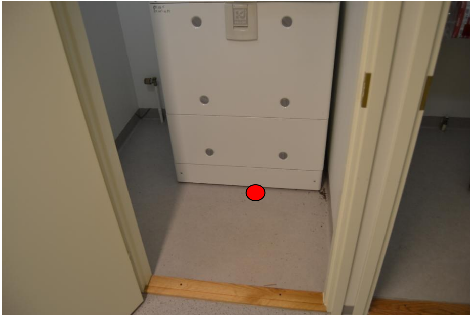
13.Tila 105 A: ilmanvaihtokoneen eteen.
