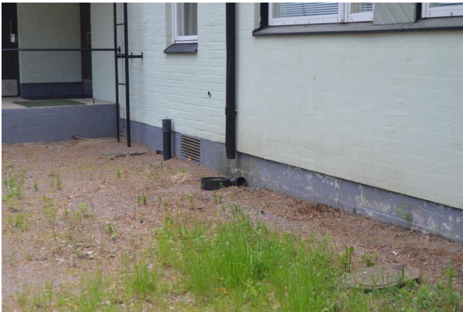
Irronnut salaojaputken alaosa. Sadevesi pääsee kastelemaan sokkelia. Kuva ilmaisu 2:n väliseinän kohdasta ulkoapäin.
