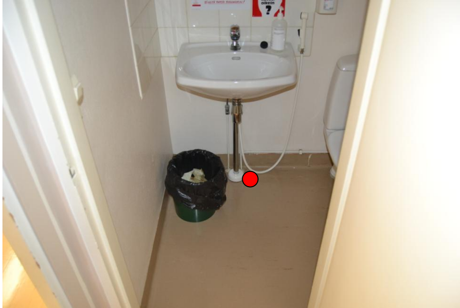
3.WC: Lavuaarin alta viemärin läpiviennin luota.
