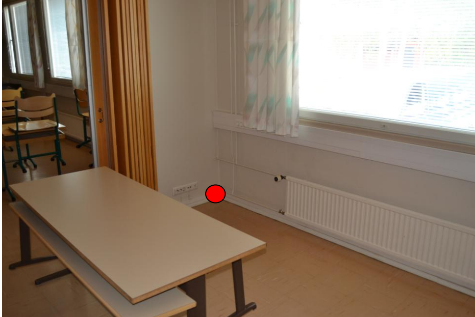
1.Opetustila, vanha ruokasali: Ulkoseinän ja haitariseinän välinen nurkkaus.
