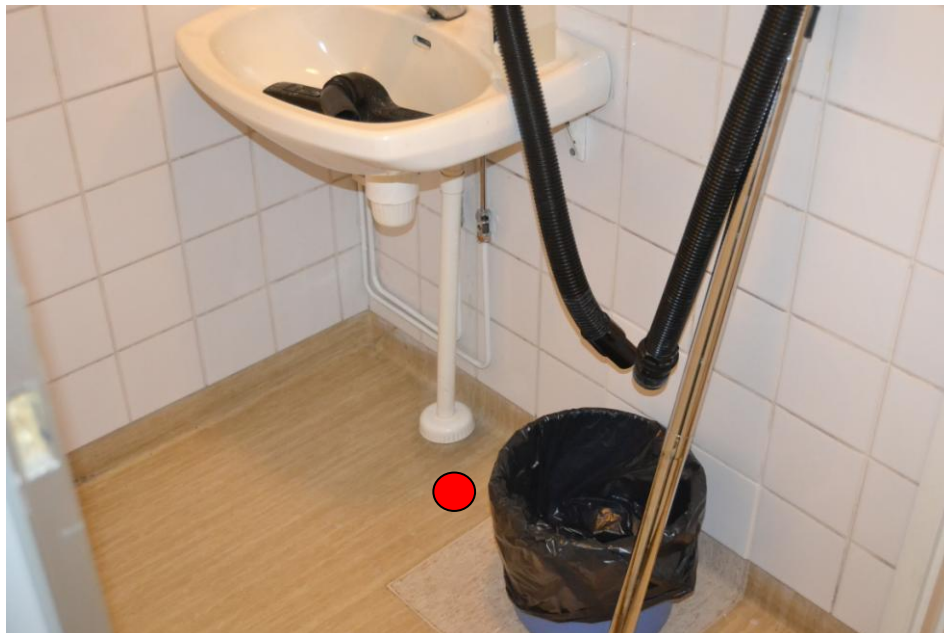
4.Oppilas WC käytävällä: Lavuaarin alapuolelta.
