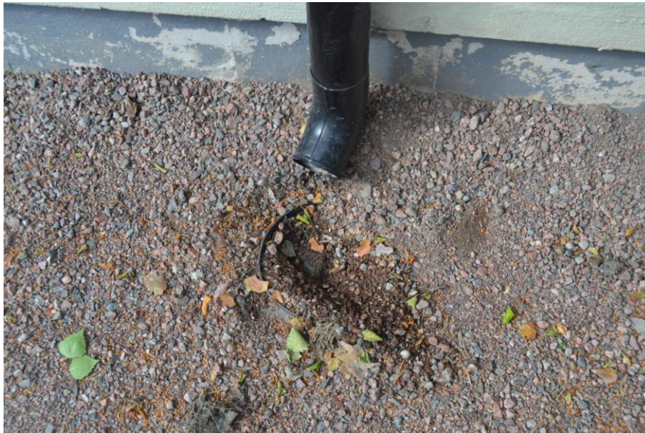
Sadeveden syöksytorven alapuolinen kaivo on soran tukkima. Kuva etupihan puolelta.
