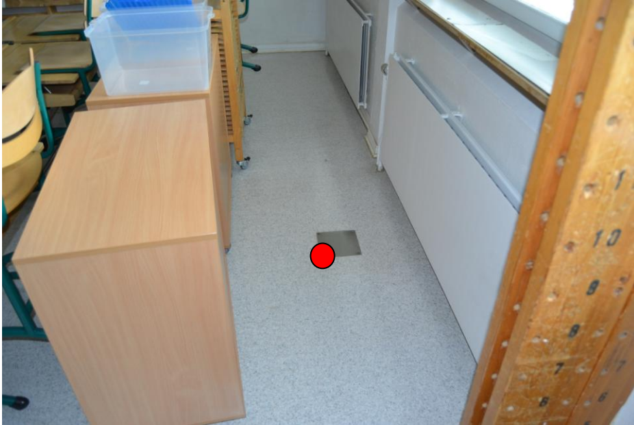
5.Opetustila 3: Lattiassa olevan metallisen luukunkannen kohdasta.
