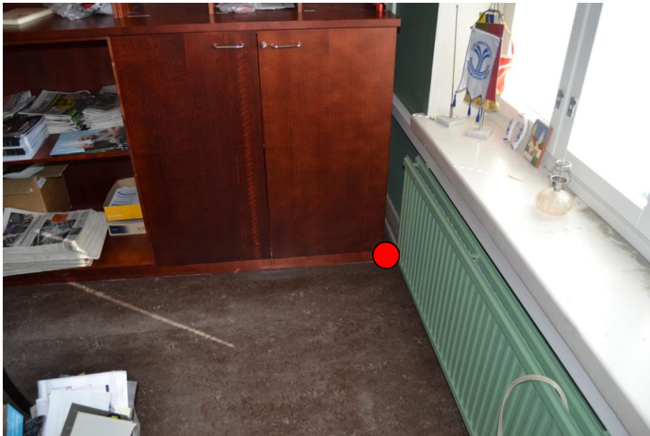
4.Opettajainhuone 2.06: Ulkoseinän ja kirjaston seinän nurkkaus kaapin luokse.
