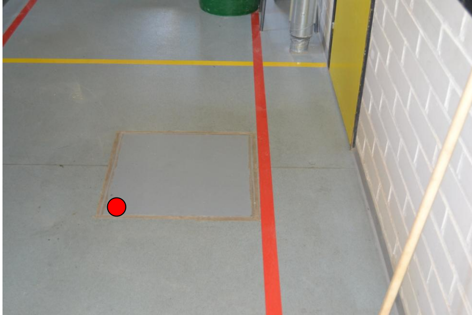
11.Puutyökonetila: Lattian alapuolisten putkistojen luukut (2 kpl)
