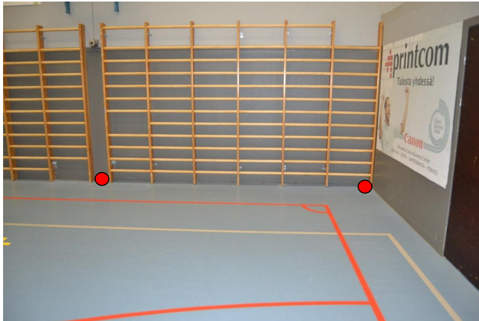
1.Palloiluhalli: Ulkoseinän ja päätyvaraston seinän nurkkaus ja ulkoseinustan luota.
