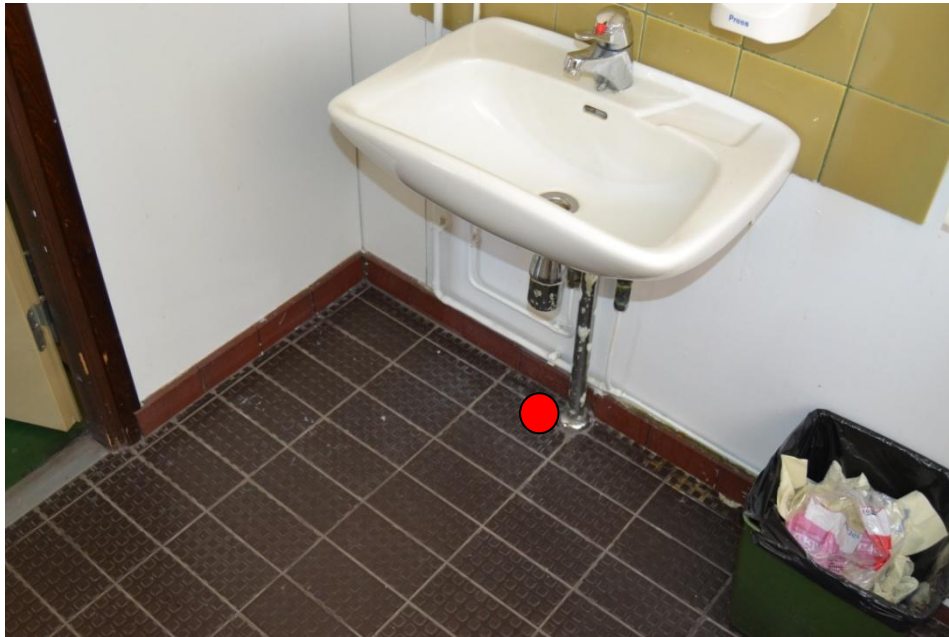
11.Inva-WC: Lavuaarin alapuolelta.
