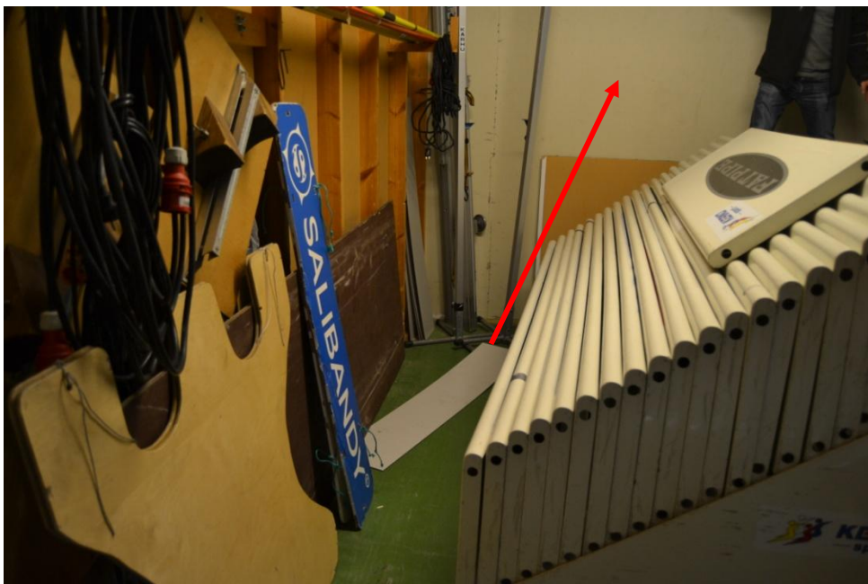
8.Välinevarasto: Ilmaisui ylös (ilmanvaihtoputki).
