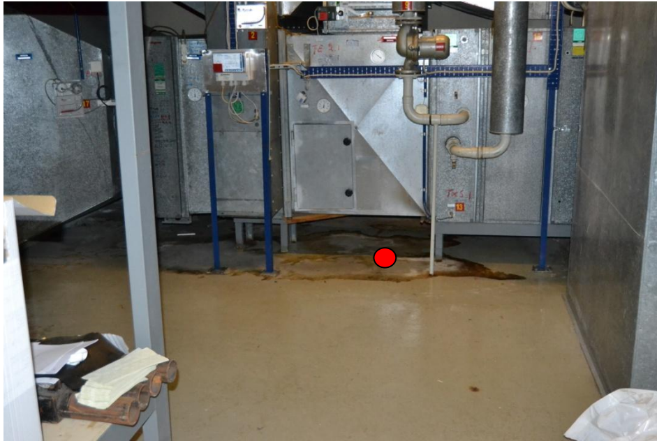
13. Ilmastointikonehuone: Laitteistojen alapuolelle.
