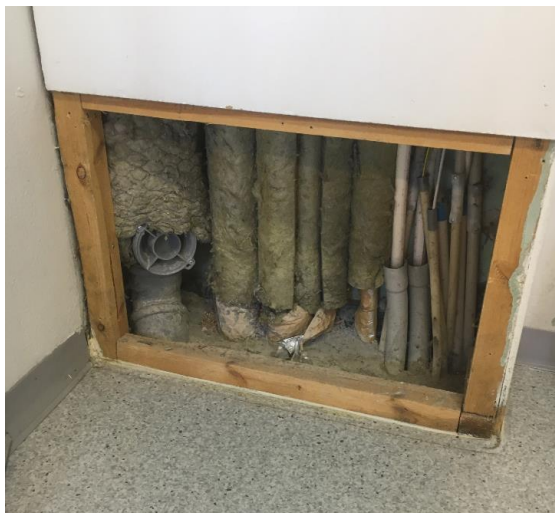
Kuva 13. Laajennusosan nousukuilu avattiin luokassa 0.32. Putkiläpiviennit tehdyn merkkiainekokeen mukaan ilmatiiviitä.
