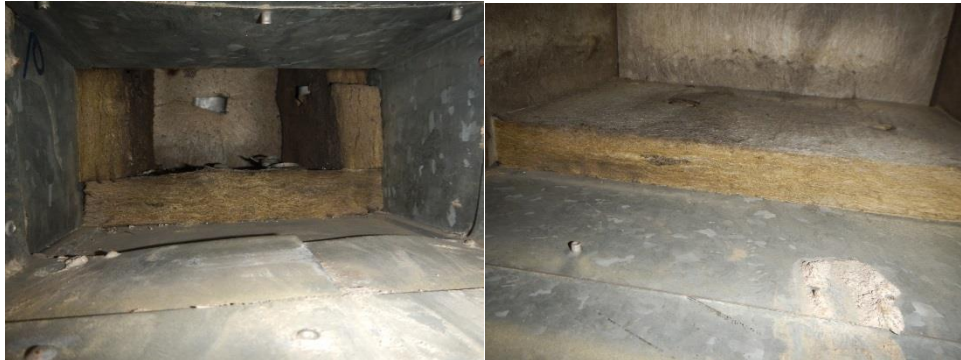
Kuva 15. Tilan 2.05 (vasemmalla) ja tilan 1.07 tuloilmapäätteet, joissa havaittavissa mineraalivillaa.
