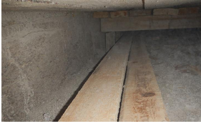
Kuva 6. Välipohjarakenteissa vanhoja irtolautoja ja muottilaudoitusta
