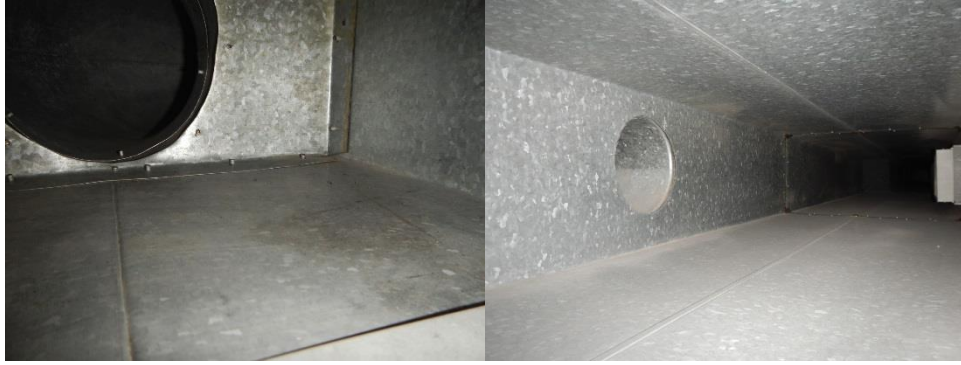
Kuva 14. Tilan 0.10 (vasemmalla ) ja tilan 0.32 tuloilmakanavat.
