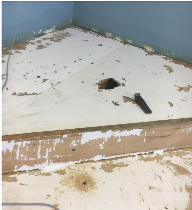
Kuva 8. Rakenneavauskohta 16 luokassa 3.01. Avauskohdasta havaittiin mikrobiperäistä hajua, mutta rakennusmateriaaleissa ei avauskohdassa havaittu kosteuden aiheuttamia jälkiä.
