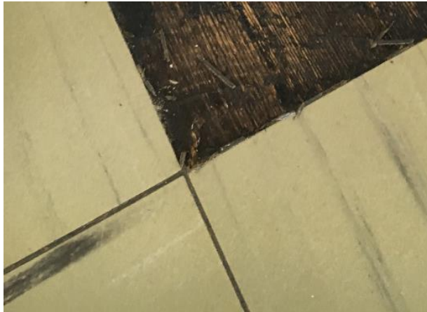
Kuva 10. Luokan 2.22 vinyylilaatta ja alapuolinen musta liima sisältää asbestia.
