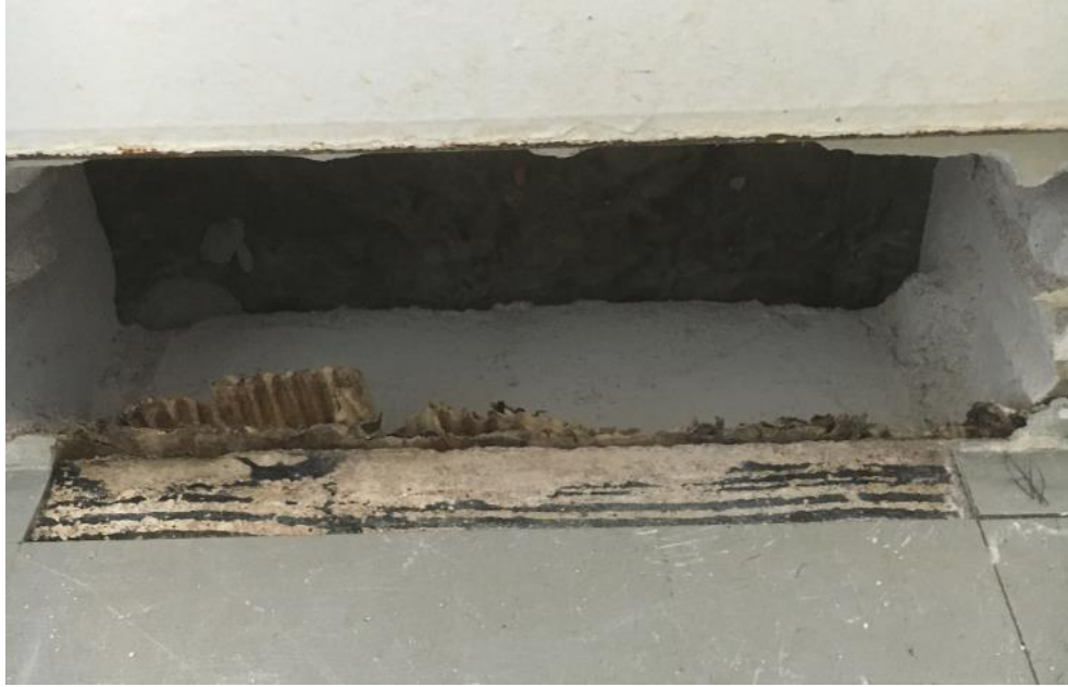
Kuva 7. US1 rakenneavaus tilassa A3.26. Tiilen ja lattian betonilaatan välissä pahvinen irrotuskaista. Eristetila jatkui n. 25 cm lattianpinnan alapuolelle.
