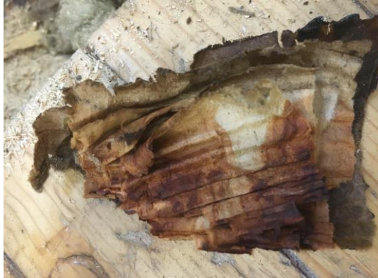
Kuva 14. Puuverstaan lattian putkieriste on mikrobivaurioitunut.
