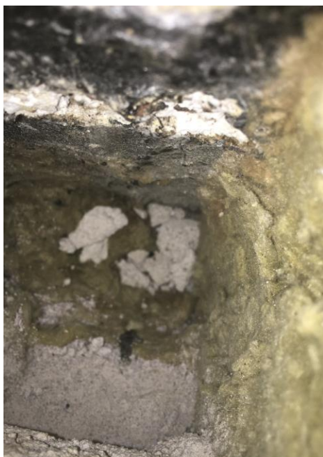
Kuva 6. Rakenneavaus 2 ulkoseinään luokassa 1.19. Ulkoseinän mineraalivillaeriste jatkuu lattiantason alapuolelle n. 20 cm. Betonilaattaa vasten olevasta mineraalivillasta otettiin materiaalinäyte seinän alaosasta. Materiaali oli viljelytuloksen perusteella kunnossa.
