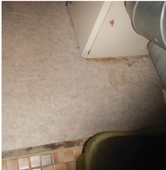
Kuva 16. IV-konehuoneessa havaittiin muovimattolattiapinnoitteen alapuolella kosteutta.
