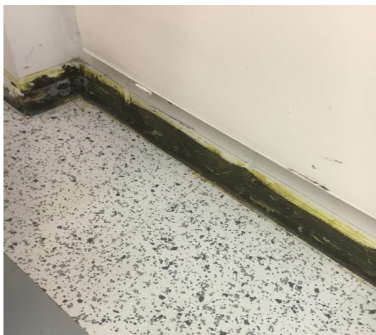
Kuva 5. Luokassa 1.19 ulkoseinän ja lattianraja oli tiivistetty. Saatujen tietojen mukaan tiivistyskorjaukset on tehty 1. kerroksessa lukuunottamatta kotitalousopetuksen tiloja.
