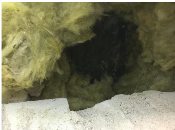
Kuva 18. Ulkoseinän US1 eristetila jatkui n. 10 cm lattiapinnan tason alapuolelle. Mineraalivillaeristeestä otettiin näyte mikrobiviljelyyn lattiatason alapuolelta. Materiaalissa on viite mikrobivauriosta.
