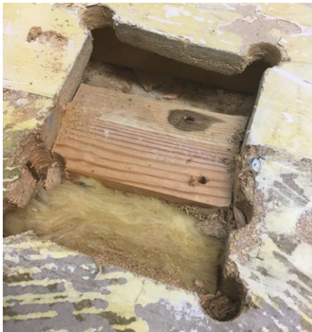
Kuva 12. Luokissa 3.02 ja 3.03 on lattian vanhan betonilattian päälle tehty korotettu puulattia. Rakenteet olivat avauskohdassa 3 aistinvaraisesti arvioiden hyvässä kunnossa.
