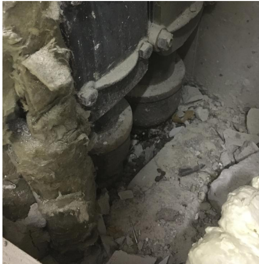
Kuva 9. Luokan 1.19 nurkassa on luukku putkikuiluun. Luukku avattiin ja havaittiin luukun pohjalla olevan kevytsora ja putkieristeet menivät maapohjaan.
