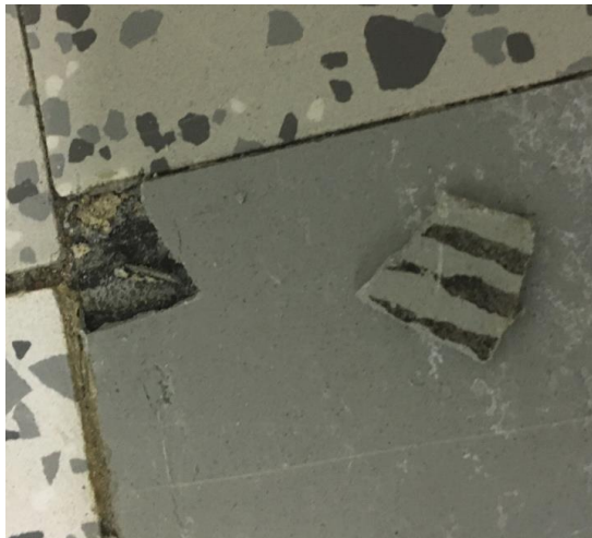
Kuva 4. Opetuskeittiön 1.35 ja Luokan 1.19 harmaa 25*25 cm kokoinen vinyylilaatta ja alapuolinen musta liima sisältää asbestia. Vinyylilaattaa on käytetty myös muissa luokkatiloissa.
