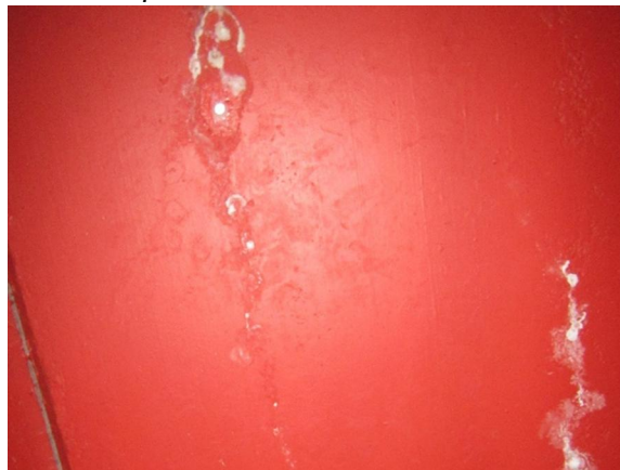
Tila 114 ontelolaatan alapinnan mineraalisäostumia ja vettä
