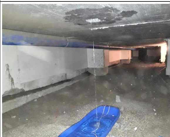
17. Alapohjan ontelolaatan avatusta kuivatusreiästä valuvaa vettä
