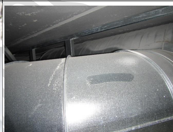
49. Käytävän alakaton yläpuolella sijaitsevien IV -kanavien päällä oli runsaasti rakennusaikaista pölyä
