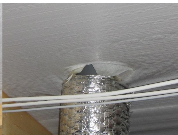
57. Aluskatteen reikä putkiläpiviennin kohdalla
