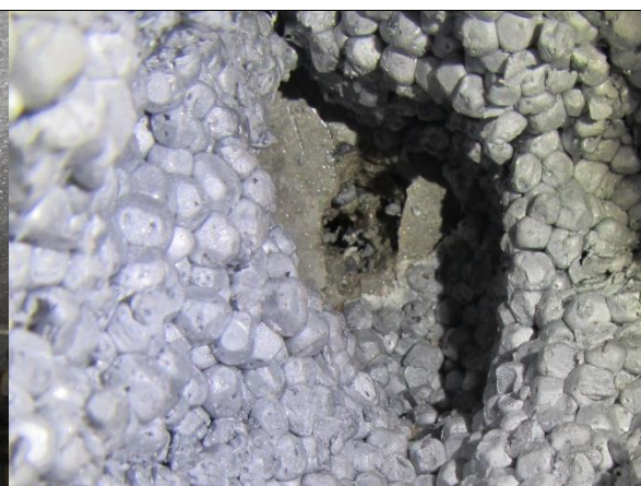
16. Vettä alapohjan ontelolaatan alapinnan ja eristeen välissä
