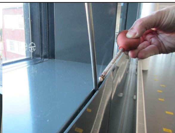
25. Ilmavuotoa ikkunaelementtien alumiinisten peitelevyjien takaa, elementin sisällä paljasta eristevillaa
