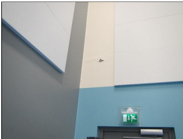
18. Pinnoitevaurio liikuntasalin seinässä
