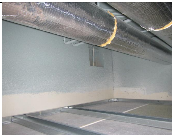
37. Luokan 208 alakaton yläpuolisia avoimia eristepintoja sekä avoin sähkösyöttökaapelin suojaputken pää
