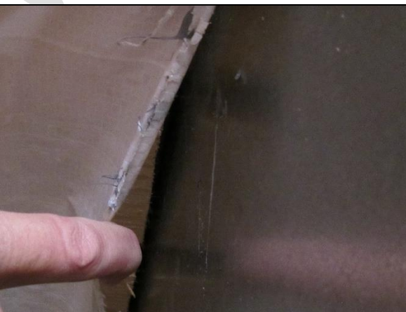
55. Puutteellisesti tiivistetty läpivienti aluskatteessa
