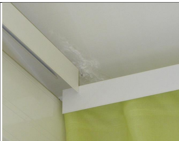
53. Katossa oleva kosteusvaurio luokassa 313
