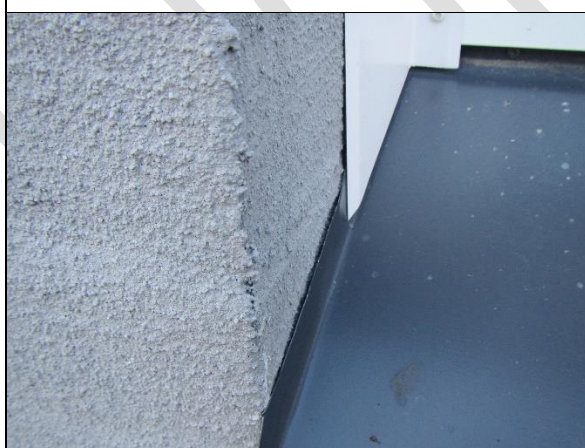
5. Epätiivis vesipellin ja seinän liitoskohta
