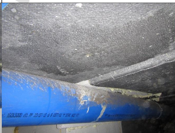
14. Märkä eristeen alapinta ryömintätilassa käytävän kohdalla
