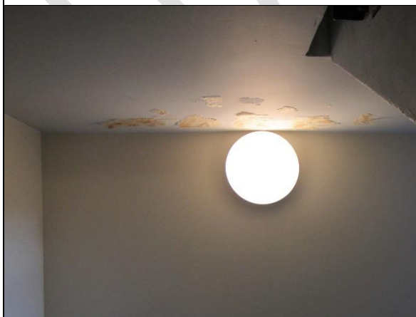
22. Porrashuoneen akustiikkalevyjen jäänteitä
