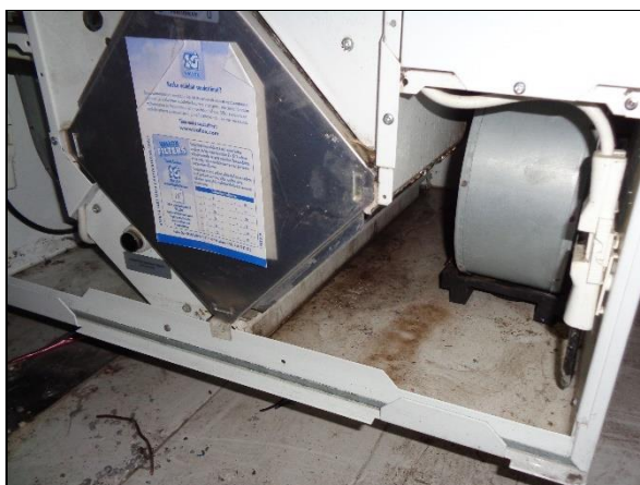
9. Alapohjan ryömintätilassa sijaitseva IV -kone
