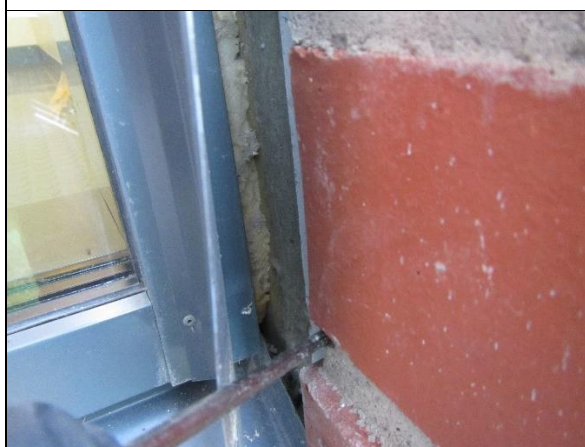
3. Epätiivis ikkunan ja seinän välinen liitoskohta
