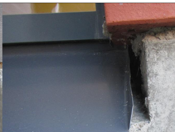
2. Epätiivis ikkunan vesipellin ja seinän liittymäkohta
