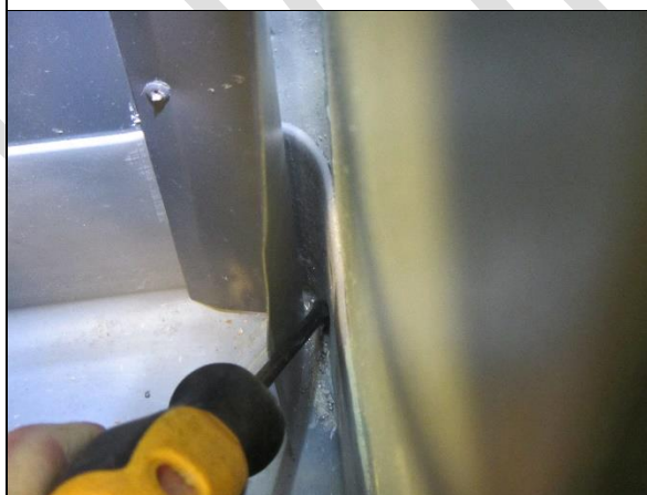
44. Ilmavuotokohta 3. krs käytän ikkunaelementin ja seinän liittymäkohdassa
