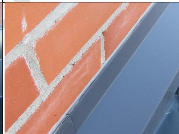
65. Puutteellisesti tiivistetty ylösnosto
