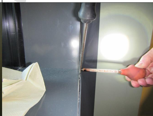
45. Ilmavuotoa ikkunaelementin paneelin takaa
