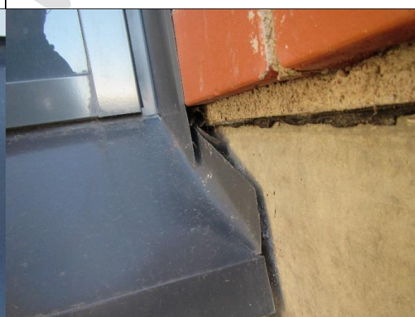
6. Epätiivis vesipellityksen liitoskohta
