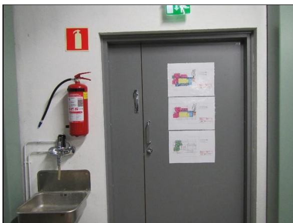
40. IV -konehuoneen epätiivis ovi
