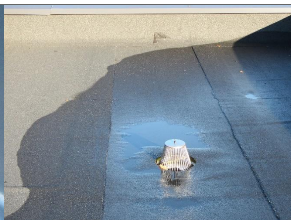
61. Lammikoitunutta vettä porrashuoneen bitumi-huopakatteen päällä
