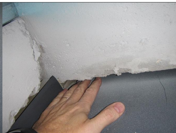
47. Epätiivisyyskohdat alakaton yläpuolisissa rakenteiden liittymäkohdissa olivat suuria
