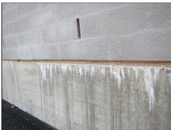
1. Kosteusjälkiä/härmää länsipuolen sokkelissa
