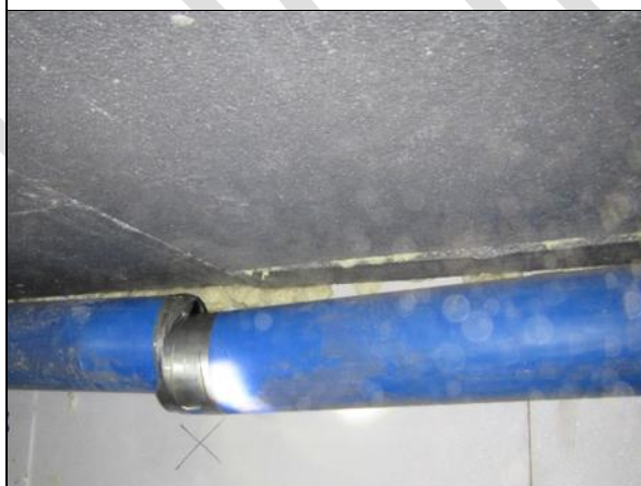
13. Ryömintätilassa sijaitseva avoin IV -putken liitos
