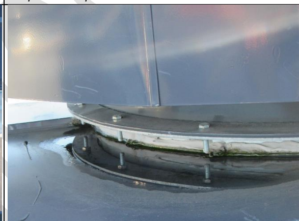
63. Vesilammikko poistoilman hajottajan reunalla
