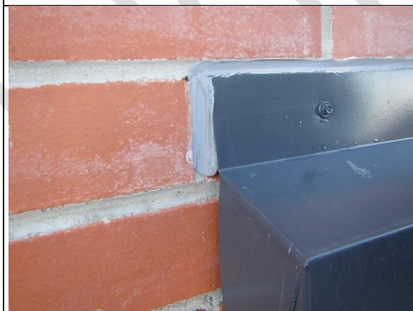
64. Puutteellisesti tiivistetty liitoskohta
