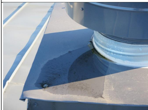
62. Lammikoitunutta vettä poistoilman hajottajan reunalla
