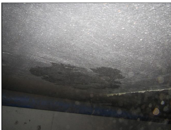
15. vesimärkä eristeen alapinta ryömintätilassa
