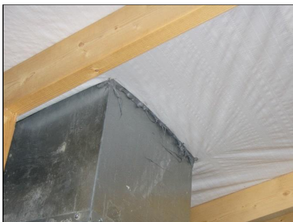
56. Puutteellisesti tiivistetty läpivienti aluskatteessa
