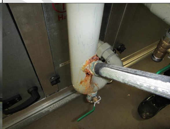
43. Vuotava putkiliitos IV -konehuoneessa
