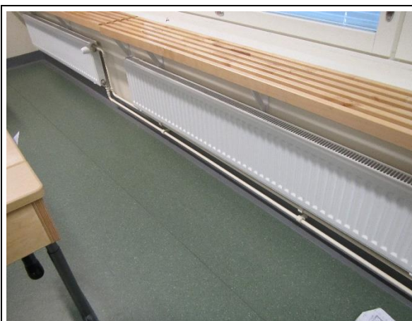
52. Kohta luokassa 310, jossa havaittiin poikkeuksellisia kosteuskokkeuksia lattiassa
