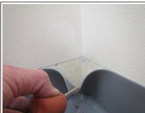
36. Luokassa 208 havaittiin ilmavuotoa lattialistan takaa rakenteesta sisätilaan päin
