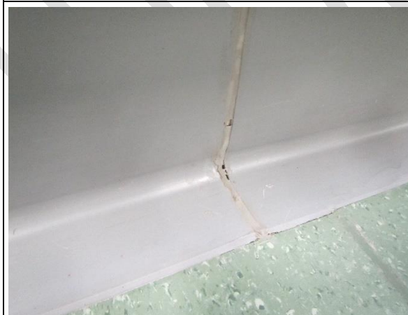
50. Luokassa 307 epätiivis lattialistan sauma
