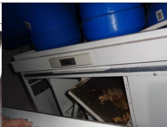
10. Alapohjan ryömintätilan likainen IV -koneen suodatin
