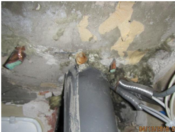
A-osa kellari, epätiivis läpivienti
