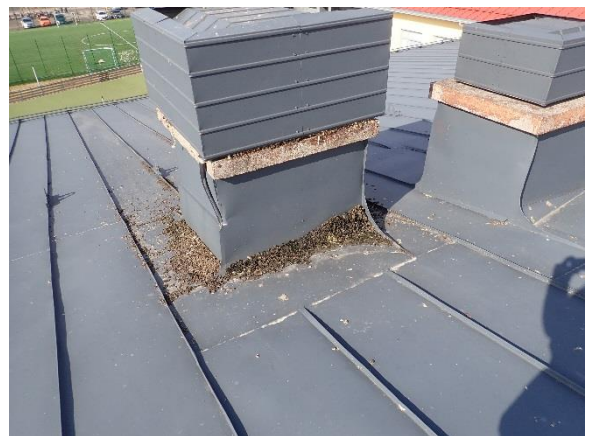
Lintujen jätöksiä poistoilmahuoneen kotelossa ja sen ympärillä
