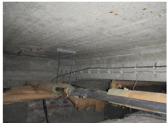
B -osa, heikkokuntoisia putkieristeitä
