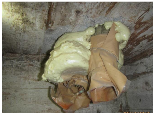
A-osa, heikosti tiivistetty alapohjan läpivienti
