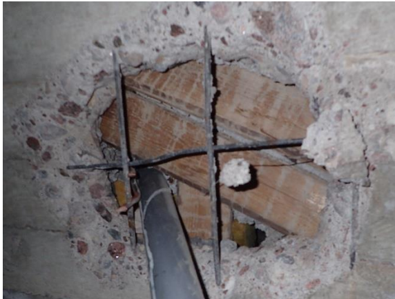
B -osa, alapohjan heikosti tiivistetty läpivienti
