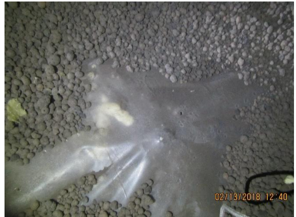
A-osa, Leca -sora kerroksen paksuus vaihteli, kapillaarikatkona olevan muovikalvon alapinnalla oli tiivistynyttä kosteutta
