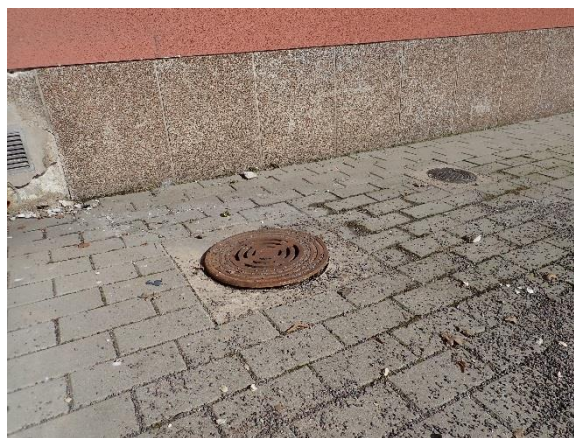
Sadevesikaivon kansi on korkeammalla kuin pihakiveyksen pinta
