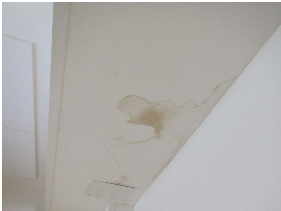
1085, vanha kosteusjälki IV-koteloinnissa
