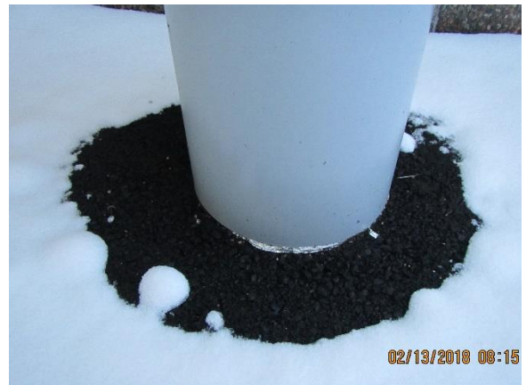
Kattilahuoneen IV-kanava rakennuksen ulkopuolella
