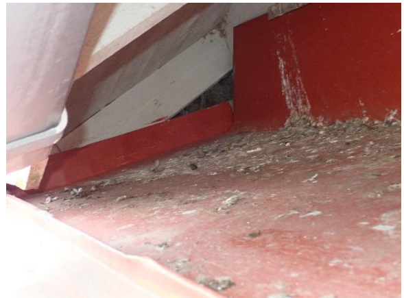
Lintujen jätöksiä B-osan sisäjiirin räystäään alla
