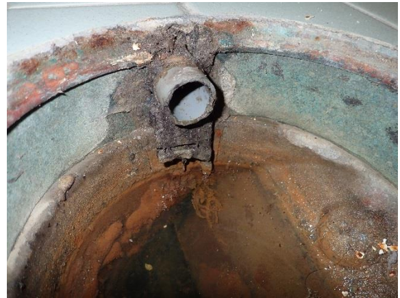
Kuparikorokerengas, liittymä kaivoon ei ole tiivis ja altaan poistoputki lävistää sen
