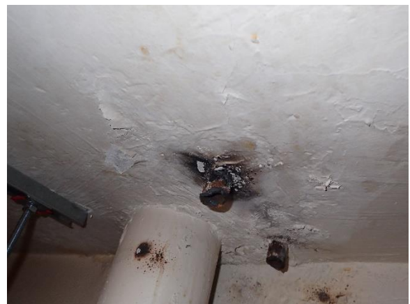
A-osa kellari, epätiivis läpivienti
