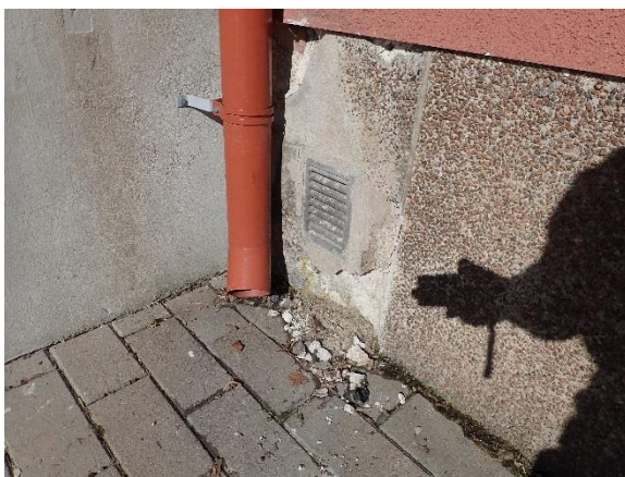
Kattovesiä johdetaan rakennuksen vierustoille
