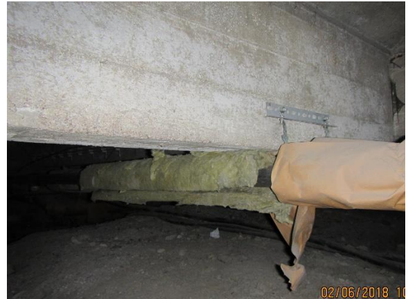
C-osa, putkilinjojen heikkokuntoisia eristeitä
