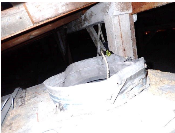
Avoin, käytöstä poistettu IV -järjestelmän osa
