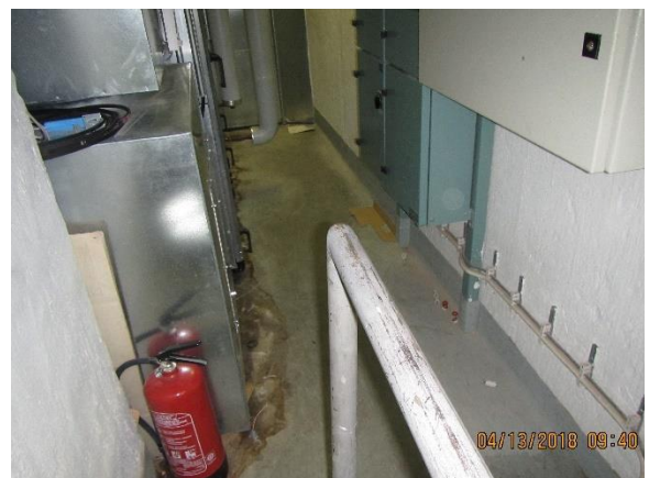
A -osa IV -konehuone, kosteusjälkiä lattiapin-nalla
