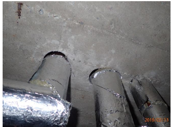
A -osa, tiivistämättömiä läpivientejä
