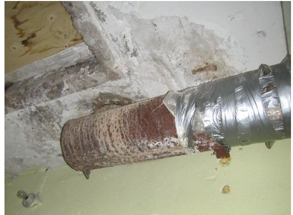
Vanhan kattilahuoneen paikattu valurautaputki
