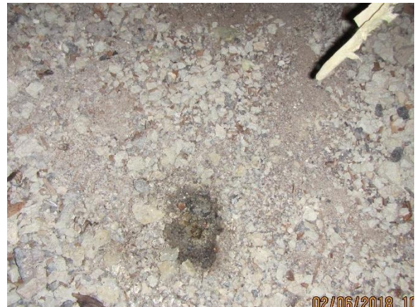
C-osa, kosteusjälki vuotavan putkiliitoksen alapuolella
