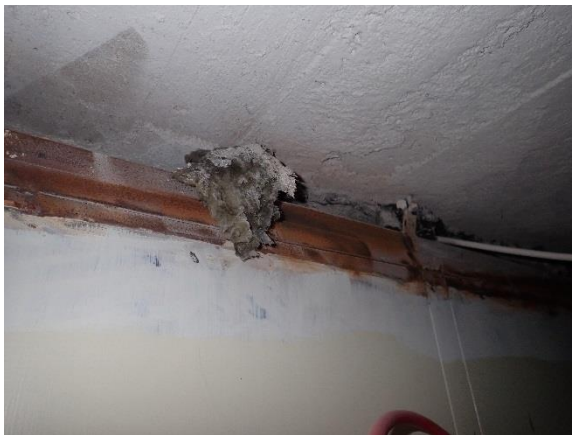
Avoim liittymä palo-oven yläpuolella, avoimia eristevillapintoja
