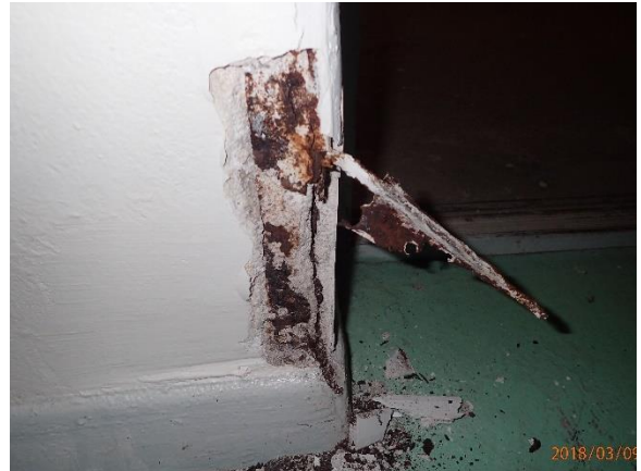
A-osa kellari, vaurioitunut seinärakenne
