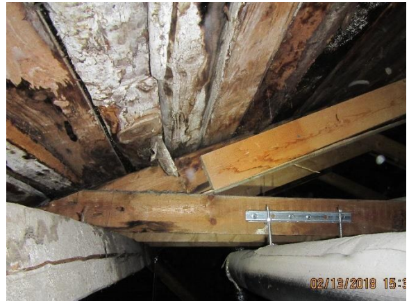
Kosteus- ja lahovaurioita
