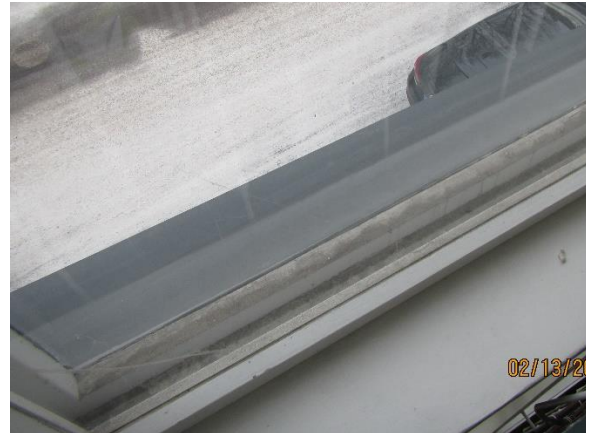
Porraskäytävä, likaa ja kosteusjälkiä
