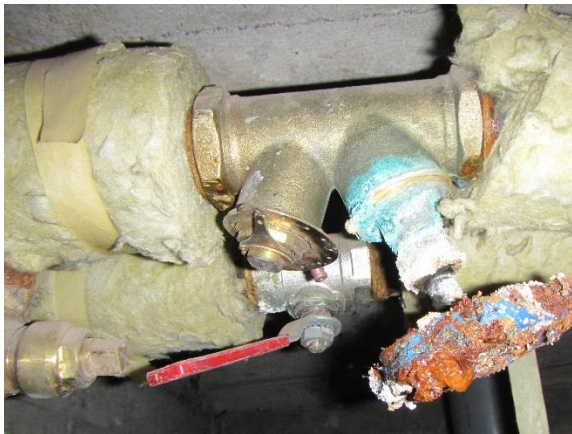
C-osa, heikosti vuotava putkiliitos
