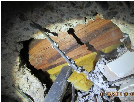
B -osa, alapohjan heikosti tiivistetty läpivienti
