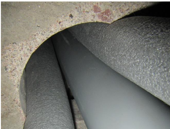
B -osa, alapohjan tiivistämätön läpivienti
