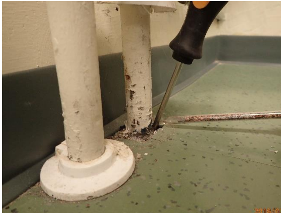
1071 c, ilmapuotoa lämpöpatterin läpivientien kohdalla
