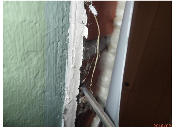
1076, epätiivis ovenkarmin ja seinän liittymä ja vanhaa pellavarivettä
