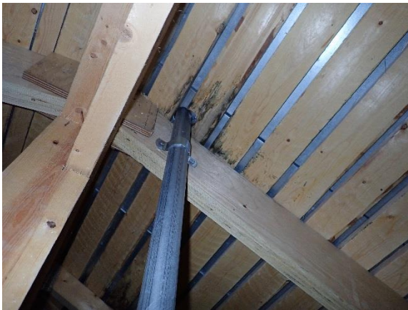
Vuotava antenniputken läpivienti vesikatossa
