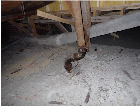
Eristämätön viemärin tuuletusputki.
