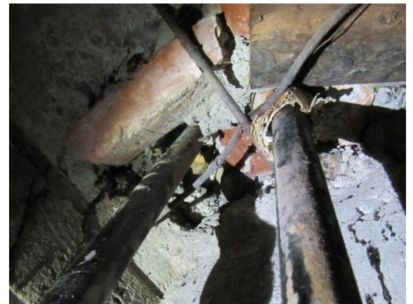
B -osa, heikosti tiivistetty alapohjan läpivienti
