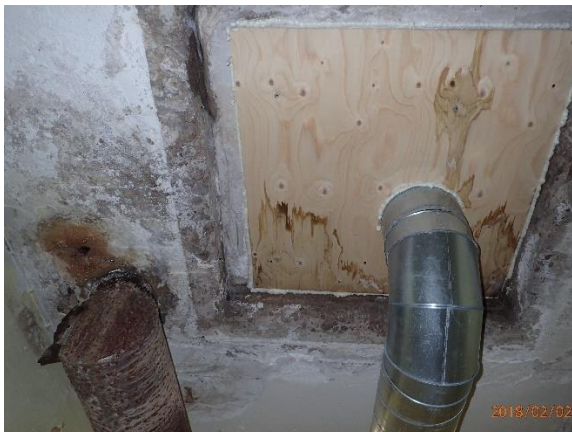
Entisen kattilahuoneen välipohjan kosteusjälkiä IV-kanavan kohdalla
