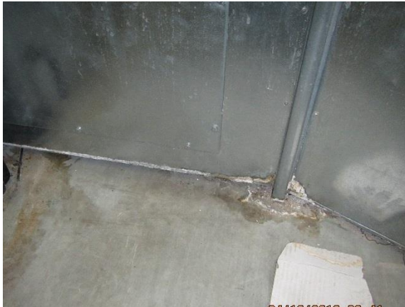
A -osa IV -konehuone, kosteusjälkiä tuloilmakammioista
