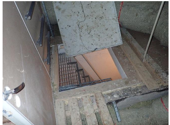
Avoin luukku sisätiloista vinttitilaan, runsaasti lintujen jätöksiä kaikilla pinnoilla
