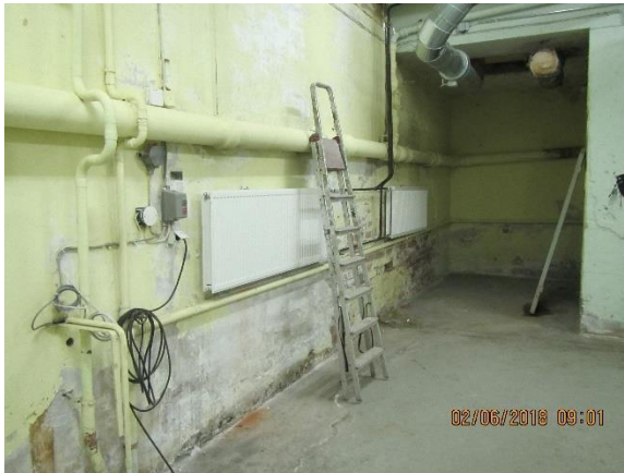
Vanha kattilahuone, kosteuden aiheuttamia pinnoitevaurioita
