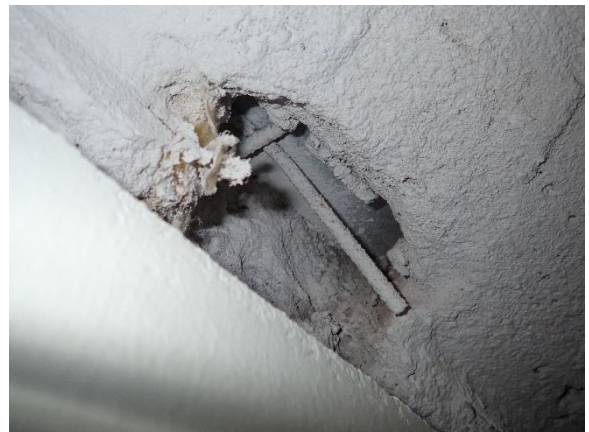
Avoim läpivienti yläpohjassa
