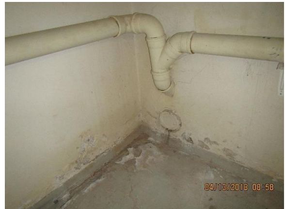
A-osa kellari, kosteuden aiheuttamia pinnoite- vaurioita
