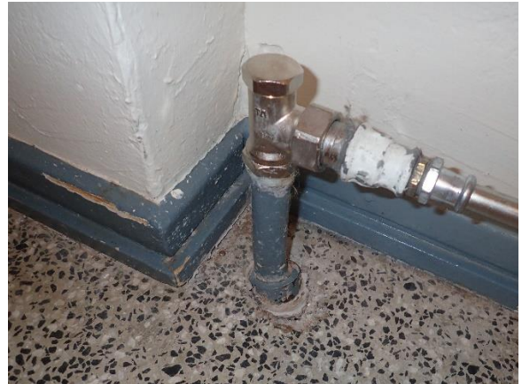
132/1078, epätiivis välipohjan läpivienti
