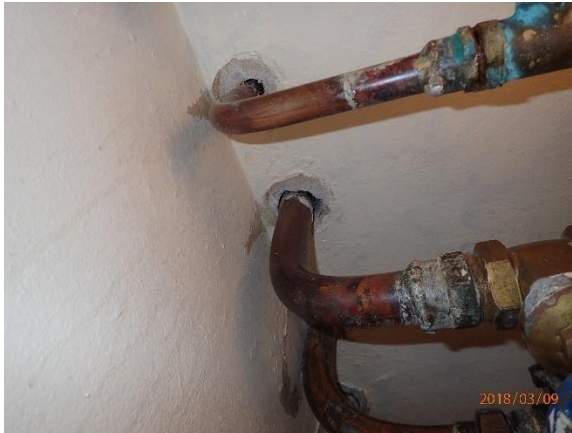
A-osa kellari, epätiivitä läpivientejä
