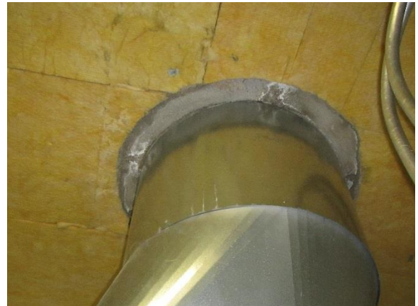
A -osa IV -konehuone, kanavan läpiviennin kohdalla oli kosteusjälkiä
