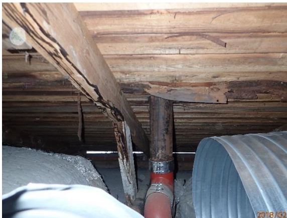
Kosteus- ja lahovaurioita
