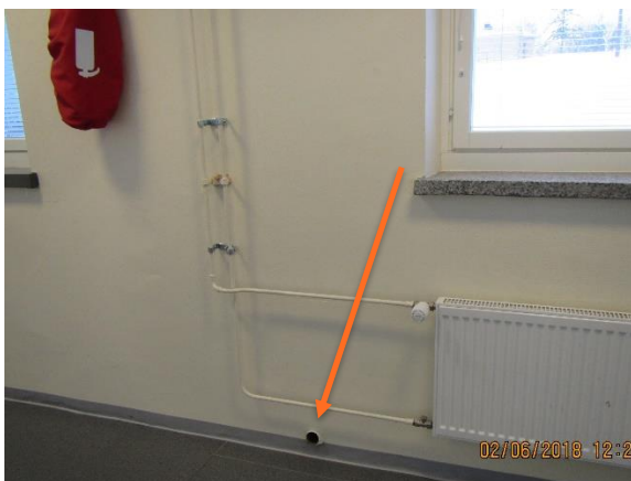
1070, käytävän ulkoseinässä oli avoin läpivienti ulos
