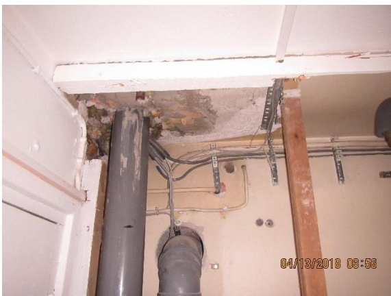
A-osan kellari, epätiivisiä läpivientejä
