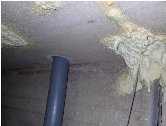
A-osa, tiivistämätön läpivienti
