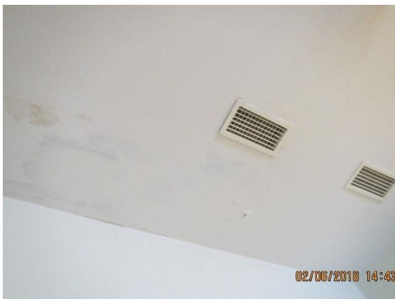
209/303, yläpohjan kosteus- ja pinnoitevaurioita
