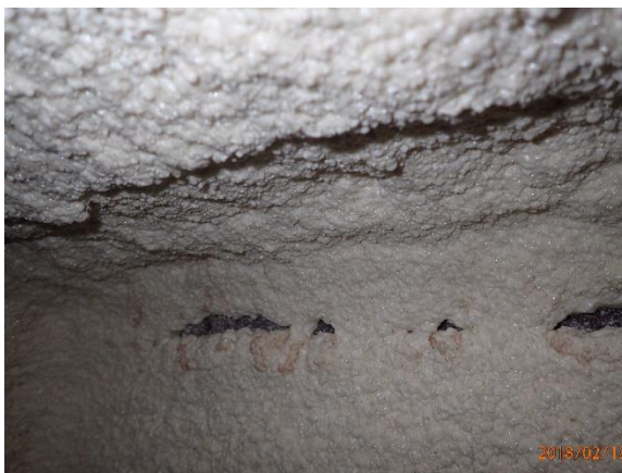
A-osa, rakoja ulkoseinän uretaanipinnalla
