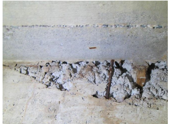
A-osa, betonirakenteessa oli puuta
