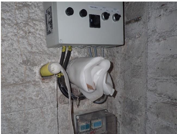
Entinen polttoainevarasto, epämääräinen tiivistys perusmuurissa (yhteys ulkopuolelle)
