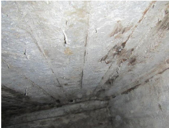
C-osa, betonipinnoilla oli paikoin lahoa muottilautojen pintaa
