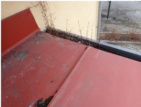
Eloperäistä ainesta B-osan vesikourussa
