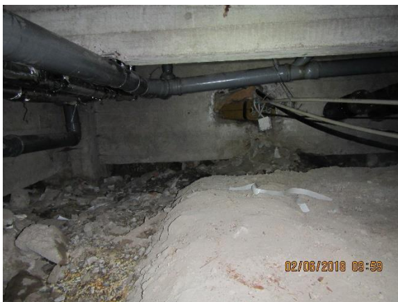
B -osa, pihan puoleisessa päädyssä alapohjan maapohja oli märkä
