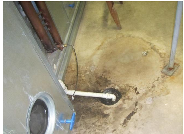
C-osa IV -konehuone, kosteusjälkiä ja likaa lat- tiakaivon ympärillä
