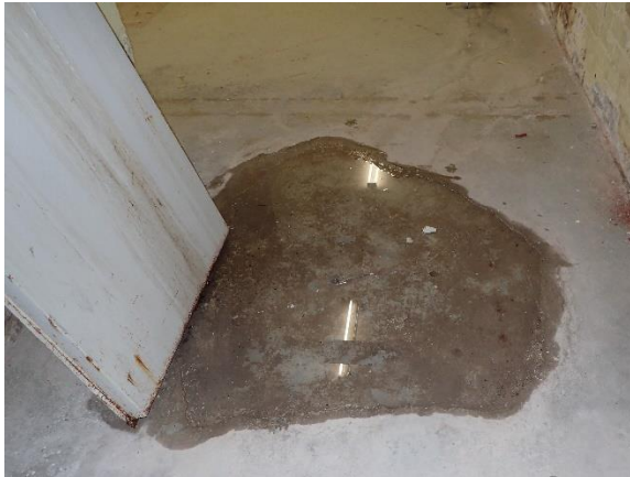
Pihakannen kanavan läpiviennin kohdalta valuu vettä kellariin
