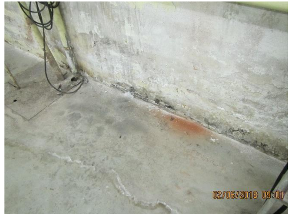
Maanvastaisen seinän kosteuden aiheuttama vauriokohta
