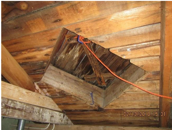
Kosteus ja lahovaurioita
