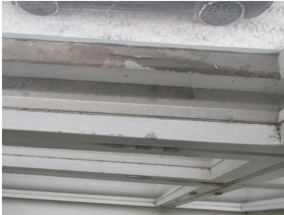
Porraskäytävä, likaiset ikkunoiden välit ja kosteusjälkiä
