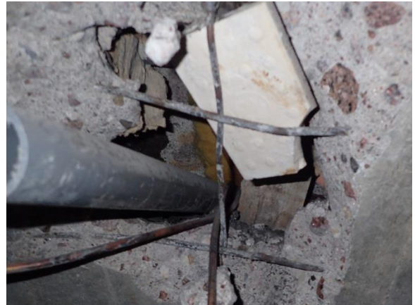
B -osa, epätiivis läpivienti
