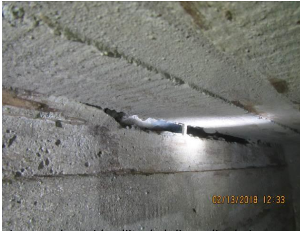
A-osa, rakenteiden liitoskohdissa oli rakoja
