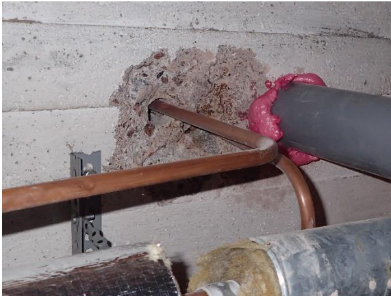
Vanha kattilahuone, tiivistämätön läpivienti
