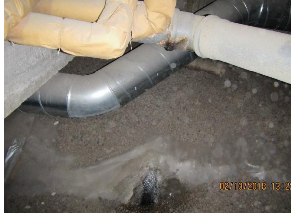
A -osa, tilassa oli vuotava viemäriputken liitos
