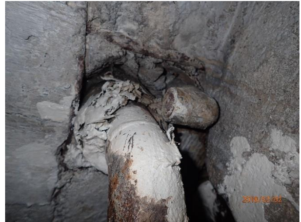
Entinen polttoainevarasto, vanha epätiivis läpivienti
