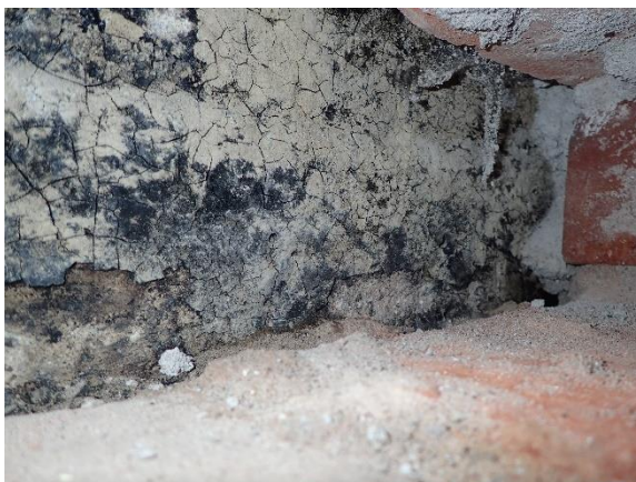
Vanha kattilahuone, epätiivis bitumisivelykerros
