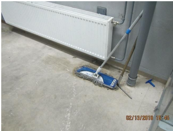
C-osa IV -konehuone, tilan lattia oli erittäin likainen
