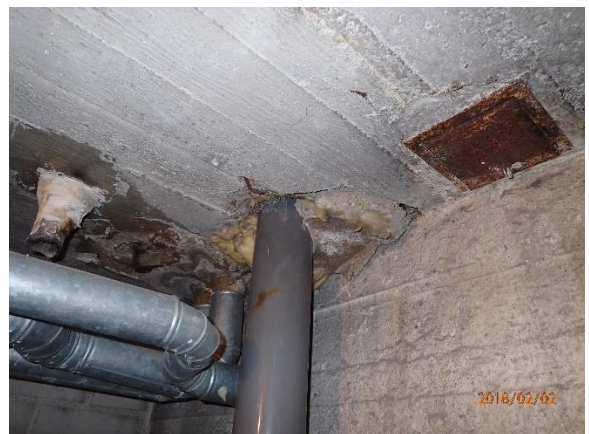
Entinen polttoainevarasto, epätiivis läpivienti
