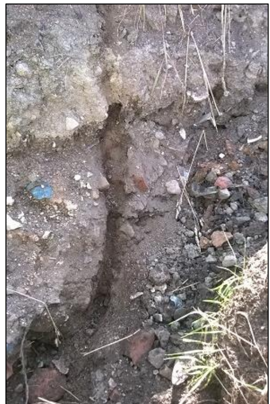
Kuva 7. Sekalaista jätettä kaivannossa 1a.
