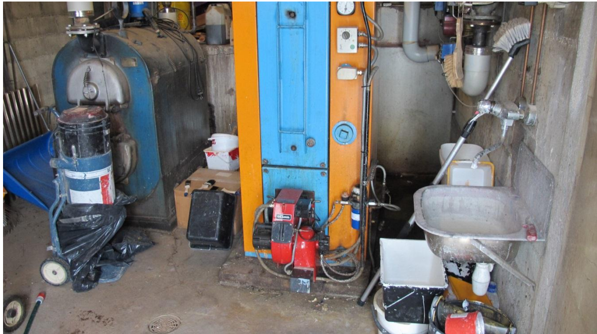
Valokuva 3.8.1. Rakennukseen tuotetaan lämpöä viereisen rakennuksen öljylämmityskattilalla.
