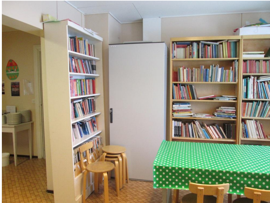
Valokuva 4.11.3. Rakennukseen on asennettu yleiskaapelointijärjestelmä datajakokappeineen.
