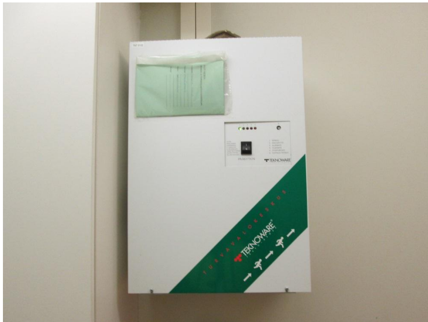
Valokuva 4.11.4. Rakennuksen turvavalokeskus on järjestelmän valaisimia huomattavasti uudempi.
