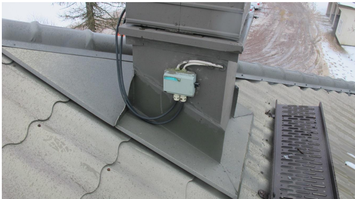
Valokuva 3.8.2. Rakennuksen vesikatolle on asennettu kaksi huippuimuria.
