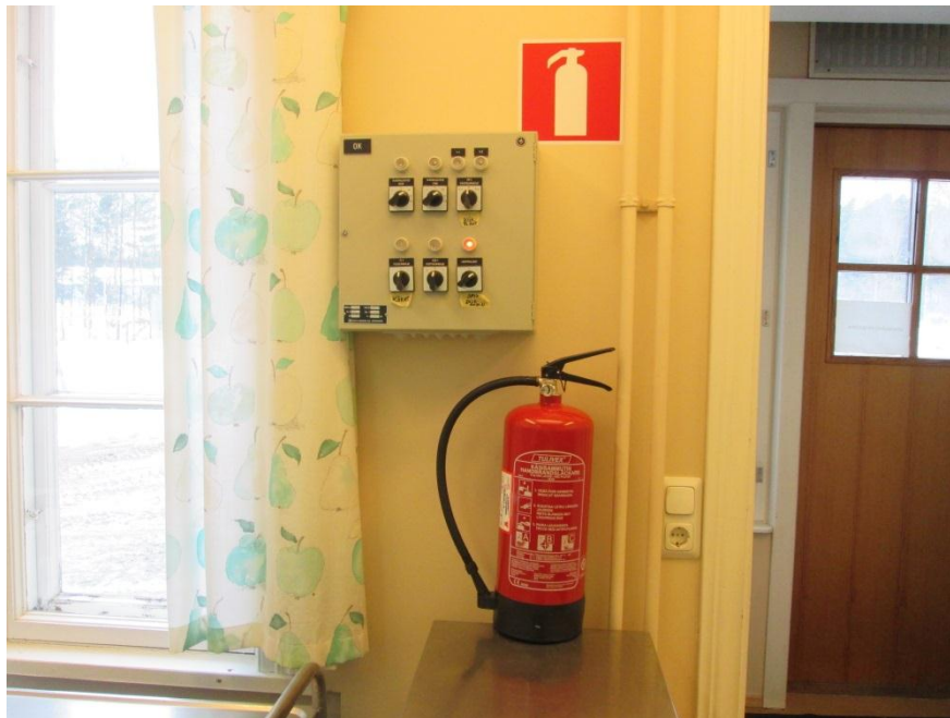
Valokuva 4.11.2. LVI- ja sähkökojeiden ohjauskeskus on sijoitettu keittiöön.
