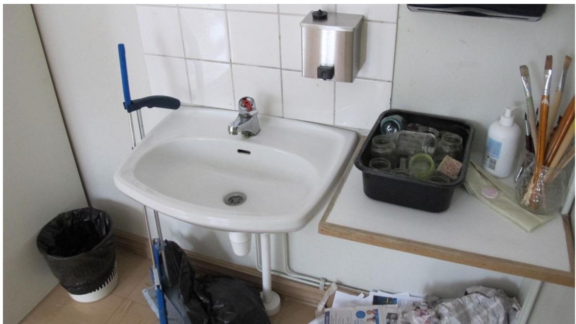
Valokuva 3.8.4. Rakennuksen vesikalusteista osa jo iäkkäitä.
