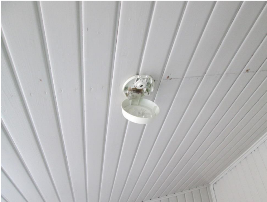
Valokuva 4.11.1. Palovaroittimessa ei ollut paristoa.
