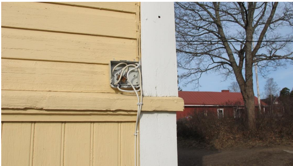
Valokuva 4.11.2. Antennin jaottimen kotelossa ei ollut kantta.
