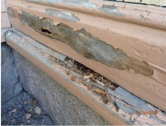
Kuva 10. Lahovaurio ulkovuorauksen alahelman vaakalaudoituksen ja tippalistan kohdalla
