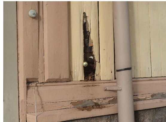
Kuva 9. Lahovaurioita syöksyputken kohdalla ulkovuorauksessa ja hirsissä
