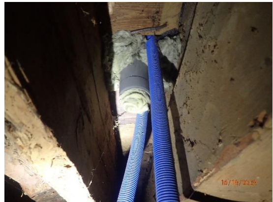
Kuva 5. Epätiivis alapohjan läpivienti
