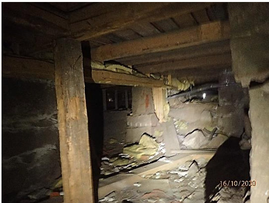
Kuva 4. Rakennusjätettä tilan 106 alapuolisessa ryömintätilassa
