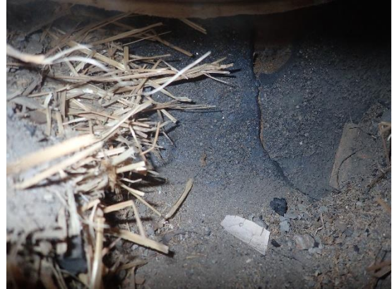
Kuva 3. Alapohjan ja ulkoseinän liittymässä oleva bitumikermikaistale sisältää runsaasti PAH-yhdisteitä
