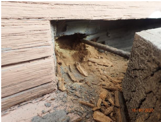
Kuva 8. Lahovaurioita ulkovuorauksen alahelmassa ja -hirsissä
