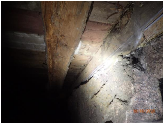
Kuva 6. Alapohjan ja ulkoseinän liittymä ei ole tiivis, liittymä tuulettuvasta alapohjatilasta kuvattuna
