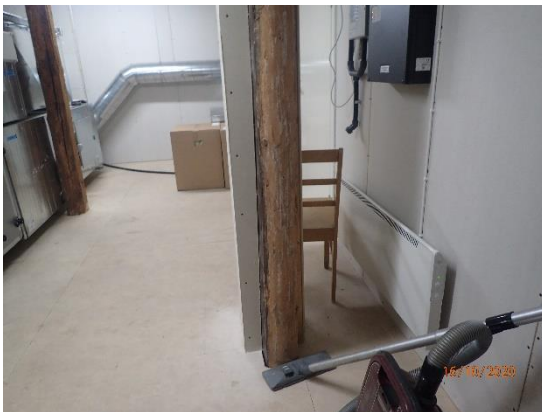
Kuva 14. Palosuojaamattomia puupilareita IV-konehuoneessa
