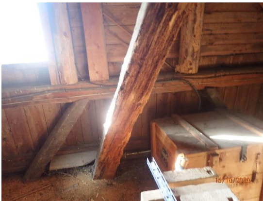
Kuva 12. Yläpohjan kantavan puurakenteen vanhoja laho- ja hyönteisvaurioita
