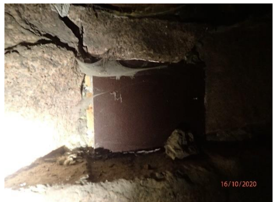
Kuva 7. Tuulettuvan alapohjan kausittaisesta tuulettuksesta ei ole huolehdittu
