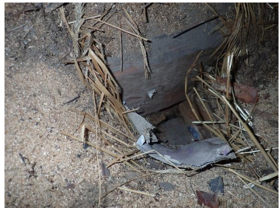
Kuva 13. Yläpohjan ilmasulkukerroksena on vanhaa tapettia
