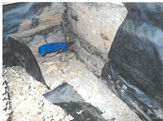
Kuva 11. Rakenneavaus 2, hirttävästen valettu betonilaatta. Bitumipaperi ei sisällä vaarallisen jätteen raja-arvon ylitäviä pitoisuuksia PAH-yhdisteitä.
