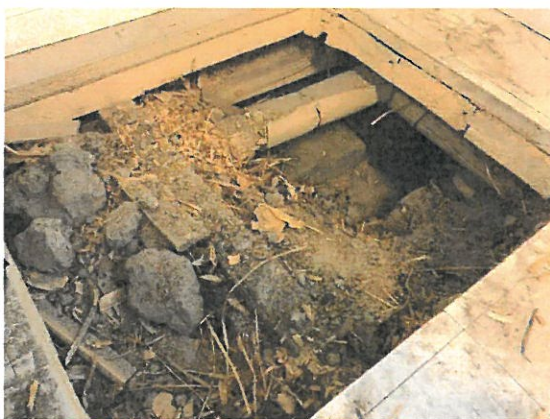
Kuva 16. Rakenneavaus 3, ryhmätila 101, alapohjarakenteessa vanhoja asbestipitoisia putkieristeitä
