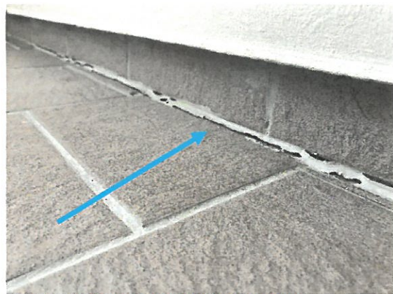
Kuva 9. Eteisaula 119, alapohjarakenteen painumisesta/elämisestä johtuva repeämä tiivistemassassa
