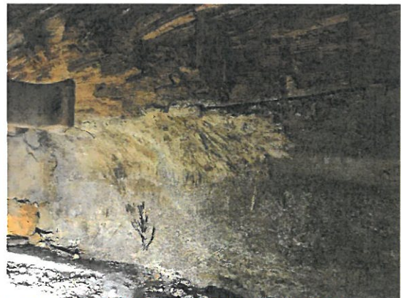
Kuva 15. Betonivaluavasten ollut hirsi oli pahoin lahovaurioitunut ulkoisen kosteusrasituksen vuoksi
