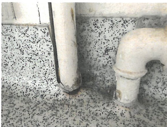
Kuva 2. Keittiö 104, epätiivis alapohjan läpivienti, jonka kautta ilmavirtausta sisäilmaan
