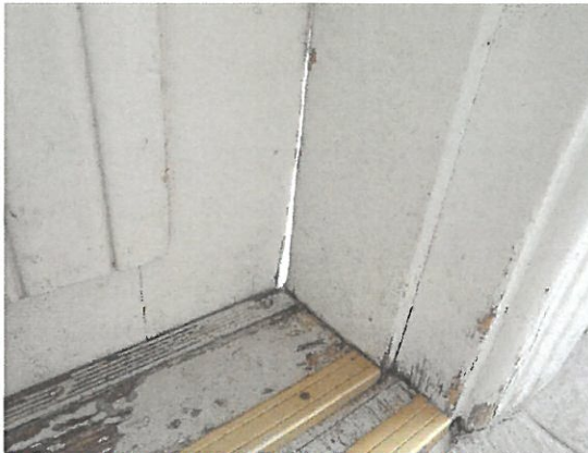
Kuva 28. Eteisaulan 107 ulko-oven näkyvä epätiivelyskohta
