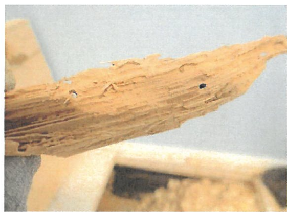
Kuva 13. Rakenneavaus 2, laho- ja hyönteisvaurioitunutta puuta
