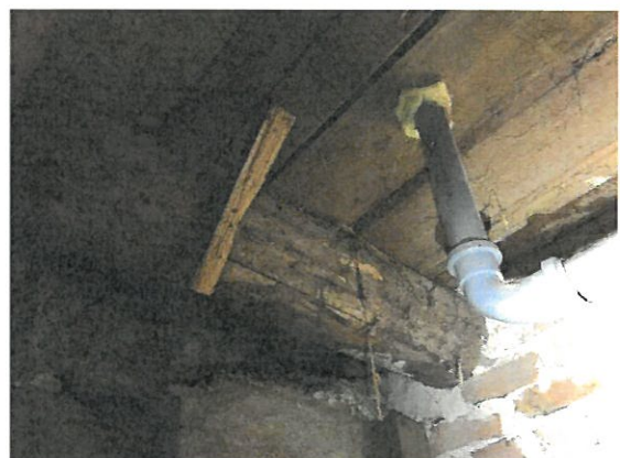
Kuva 19. Alapohjassa epätiivis viemäriputken läpivienti WC/keittiötilan kohdalla
