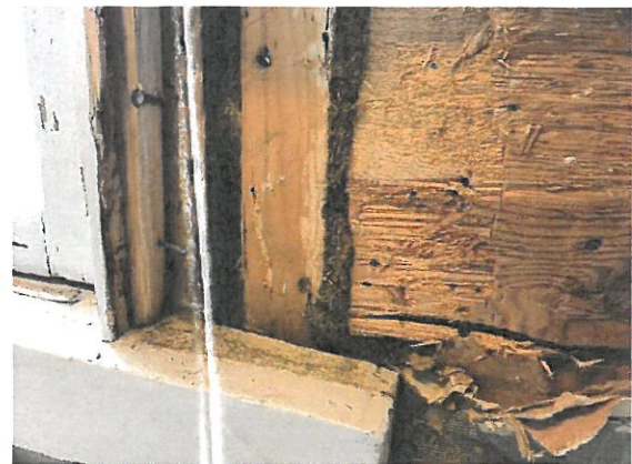
Kuva 27. Ikkunan tilkeraon eristeeseen on pellavaa tettä
