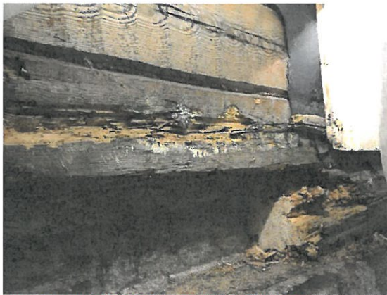
Kuva 14. Ulkoseinän lahovaurioitunut kohta rakenneavauksen 2 kohdalla
