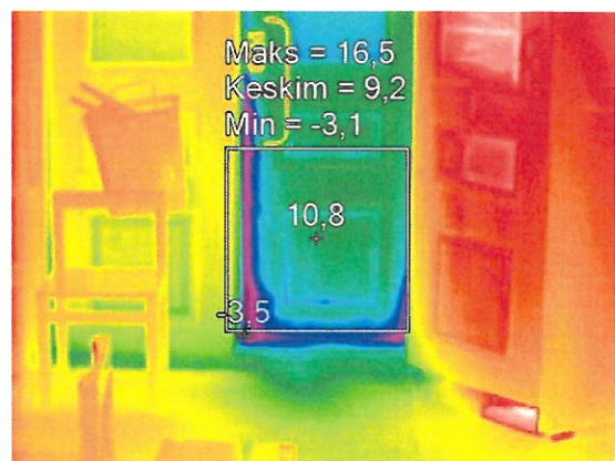
Kuva 31. Ulko-ovi on epätiivis (lämpökamerakuva)
