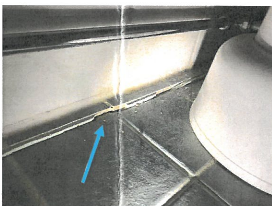
Kuva 7. WC 117, alapohjarakenteen painumisesta/elämisestä johtuva halkeama laattasaumassa
