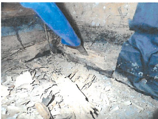
Kuva 12. Rakenneavaus 2, sekä ulko- että väliseinän alin hirsi on laho- ja hyönteisvaurioitunutta
