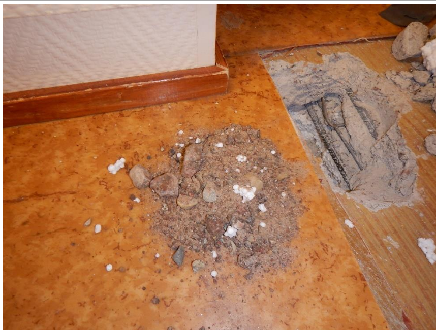
Lattiarakenteen alla pääosin hienojakoista hiekkaa, jossa on seassa karkeampaa kiviainesta (ei kapillaarikatkosoraa).
