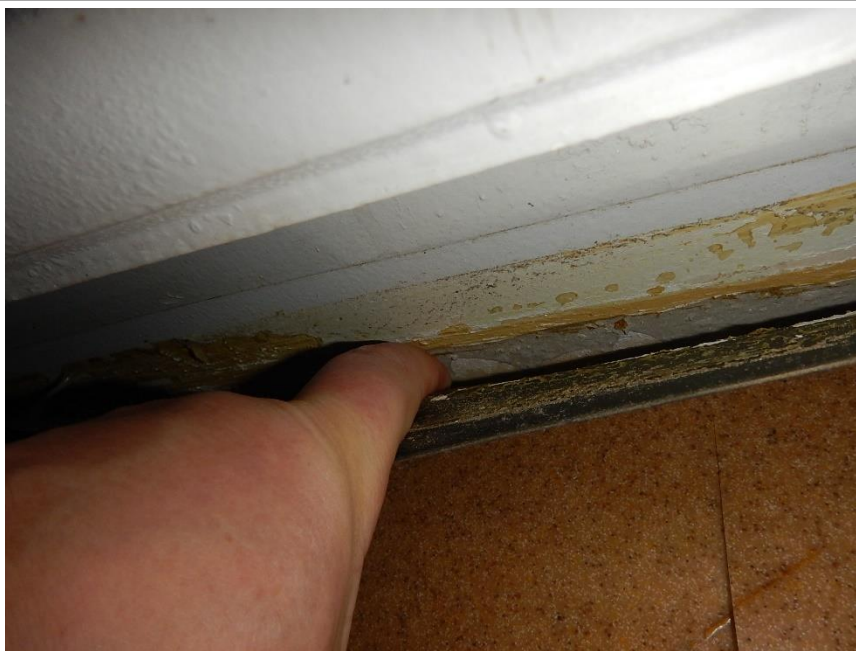
Ulkoseinän ja lattian rajassa todettiin hyvin suuri rako.
