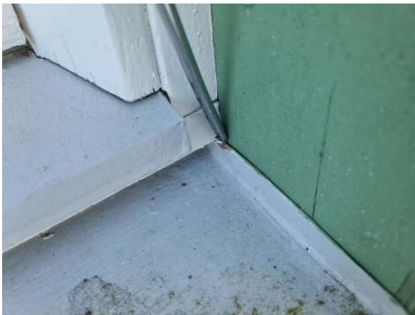
36. Vesipeltien tiivistyksissä havaittiin puutteita.
