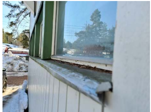
35. Vesipeltien kallistuksissa havaittiin puutteita.
