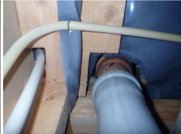
Kuva 11 Putken epätiivis läpivienti
