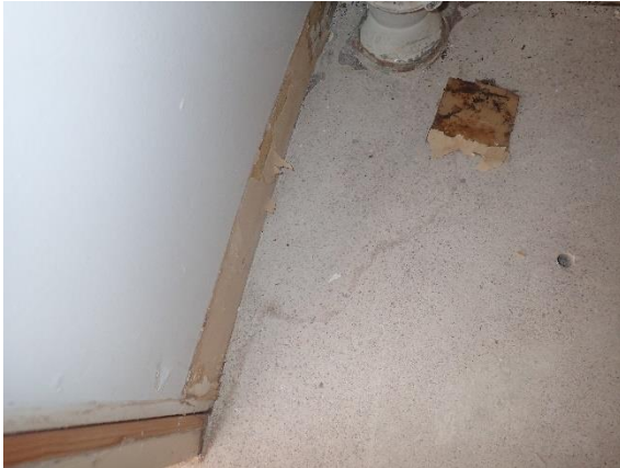
Kuva 10 Vanha kosteusjälki betonilaatassa
