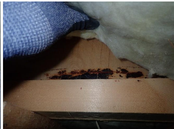
Kuva 6 Vaurioita eristeen takana puussa
