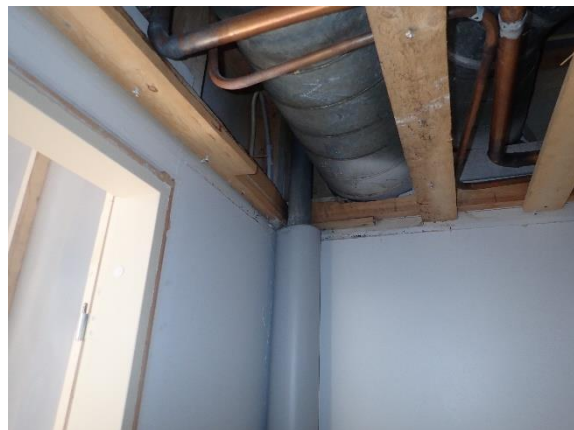
Kuva 9 Osittain lämmöneristämätön putki
