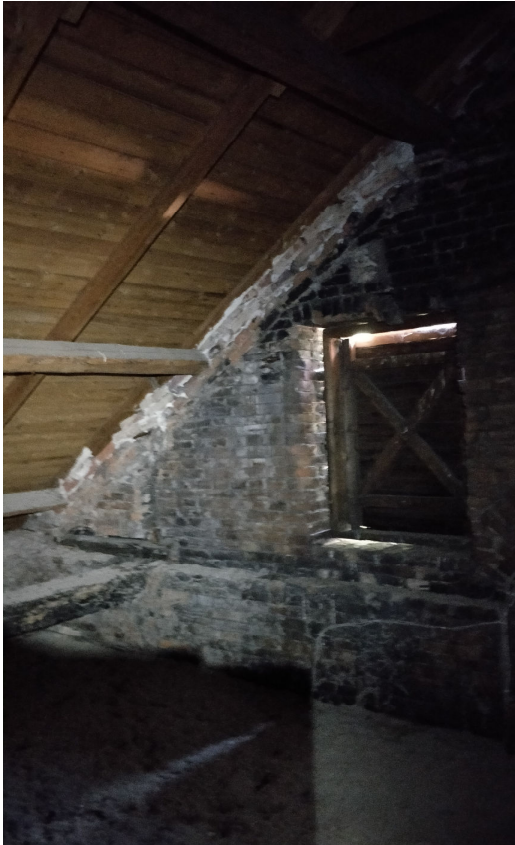
Kuva 78. Ahjosipi on alun perin ollut ilman välikattoa. Päädyssä olevia luokkuja on käytetty tuuletusta varten. Piippu jää kuvan oikealle puolelle. Myöhemmin valetun teräsbetonisen välipohjan päälle on puhallettu selluvillaeristys.
