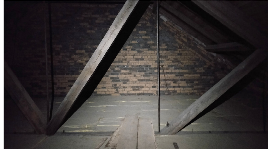
Kuva 79. Kankipajan eteläseinä ullakolta kuvattuna. Vetoteräksin vahvistetut kattotuolit ovat 1940-luvulta. Pajan kattotuolien muutosten johdosta vesikate nousi hieman. Muurattuihin päätyihin on tämän johdosta muurattu kaksi varvia vanhan päätykolmion yläosaan.
