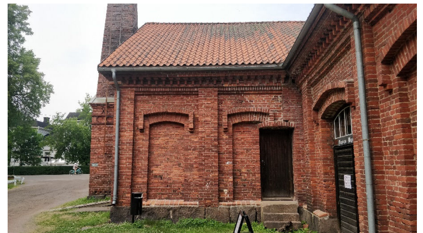
Kuva 47. Ahjosiiven eteläjulkisivussa on säilynyt julkisivun kannalta epäluontevaan paikkaan holvinkaaren viereen sijoitettu ovi, aukon sijainti on esitetty tällä paikalla jo 1930-luvun pohjapiirroksessa.
