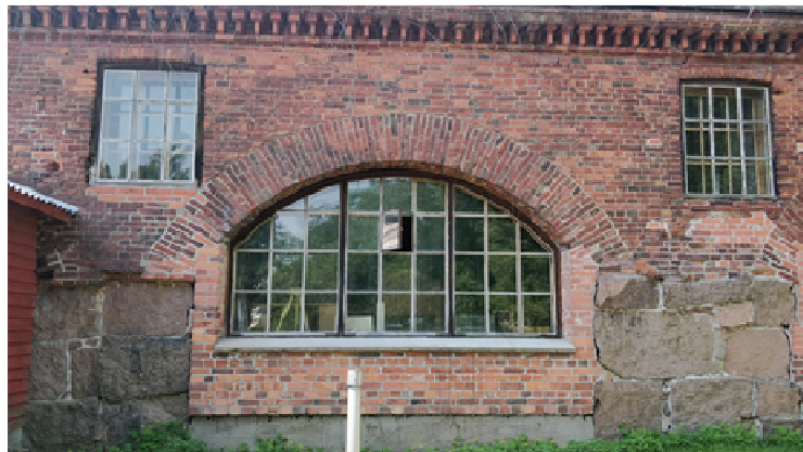
Kuva 57. Koskenpuolen julkisivussa näkyy seinän yläosan 9-ruutuiset ikkunat, jotka antoivat valoa pajaan kattoikkunoiden ohella. Kookkaaseen vesipyörää varten tehtyyn holvattuun aukkoon on 1950-luvulla asennettu 2-puitteinen kaari-ikkuna.
