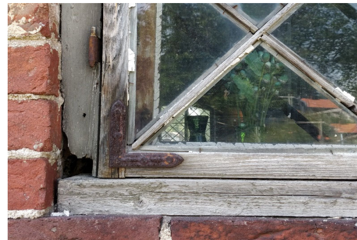
Kuva 59. Kenkäpajan kosken puoleinen ikkuna. Puuosat ja kittaukset ovat ajan syömiä. Kulmarauta ajoittaa puitteen 1900-luvun puolelle, osa karmeista on kuitenkin helojen perusteella 1800-luvun lopusta.
