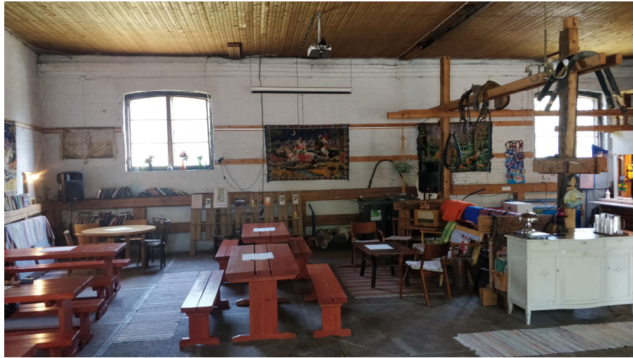
Kuva 60. Kenkäpajan sisätilaa koskelle päin. Alun perin julkisivussa on ikkunan alapuolella aukkoja ja vesiroma on kulkenut tilassa.
