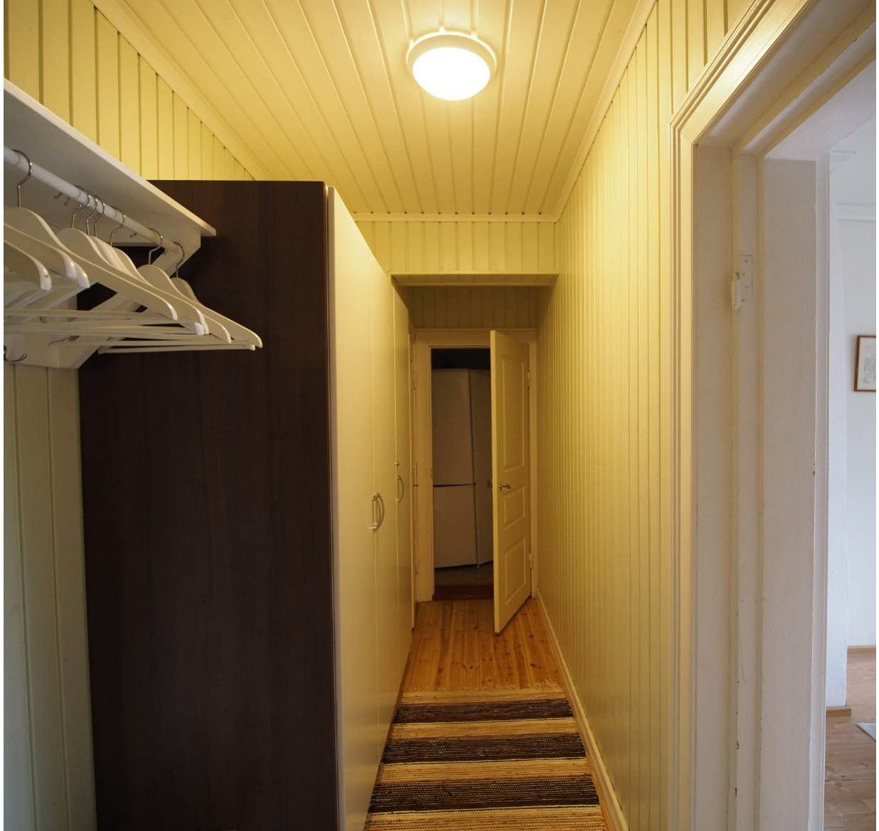
Kuva 87. Entinen pohjoispäädyn asuntoja erottanut käytävä, joka on nyt yhdistetty asuntoon neljä. Käytävän pinnat on uusittu 2010-luvulla, mutta alakattomaailmassa näkyy yhä vanhojen seinien paikkoja.
