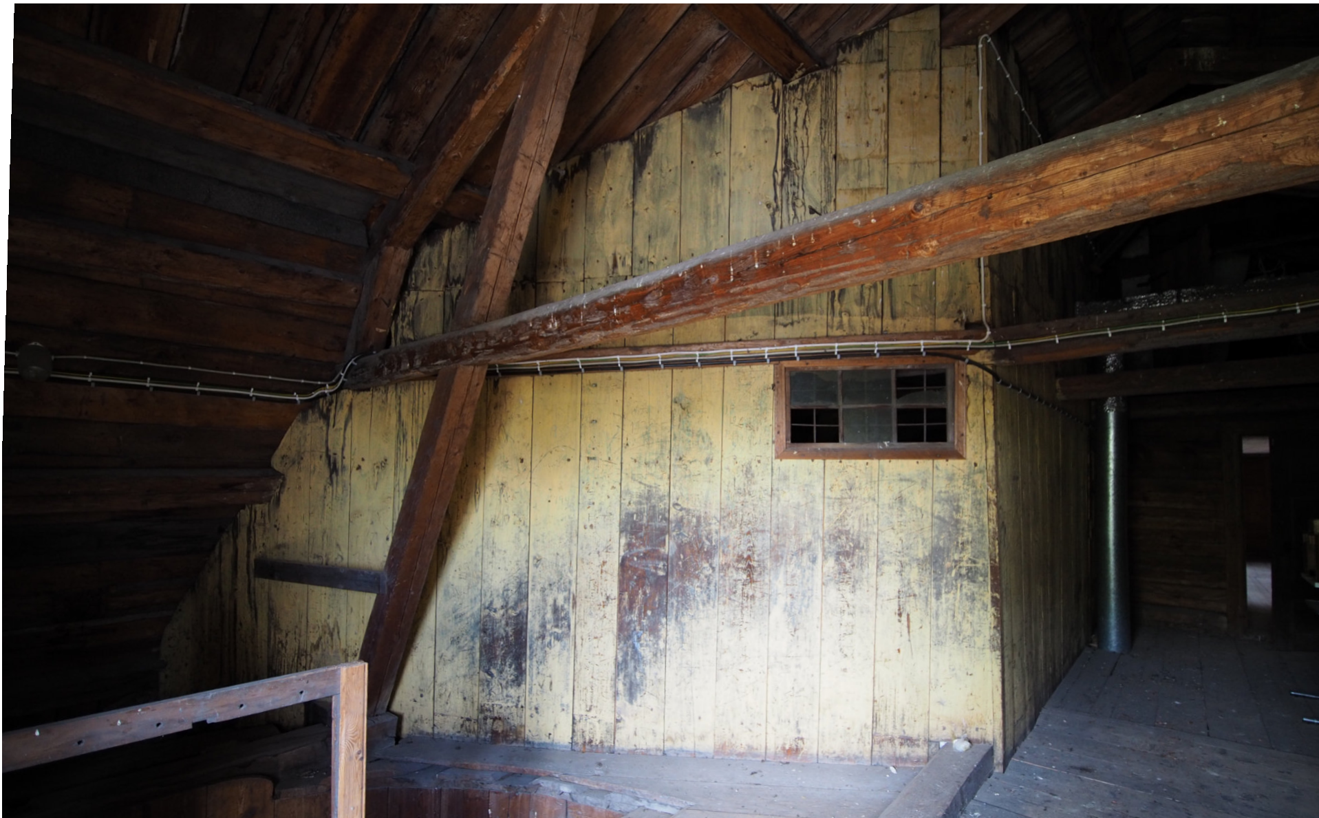
Kuva 92. Ullakon porrasulan lautaseinät on maalattu keltaisella värillä. Toisessa ullakotilassa on pieni ikkuna, joka on todennäköisesti 1800-luvulta.
