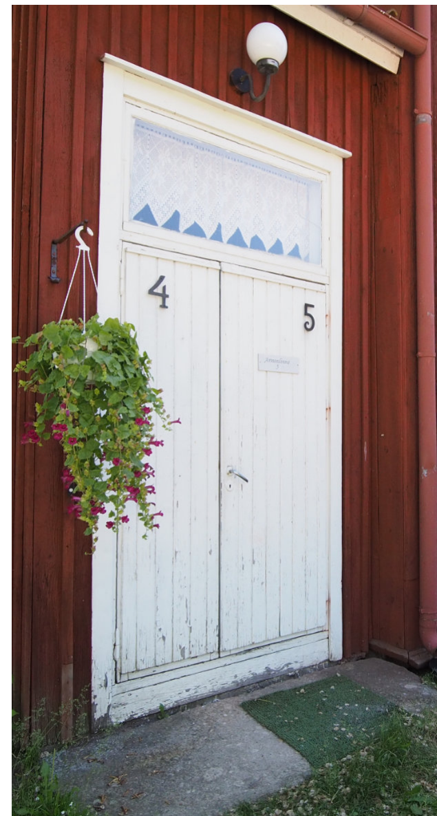
Kuva 47. Pohjoisen porrasverannan ovessa on vasikkamainen rakenne ja yläikkuna.
