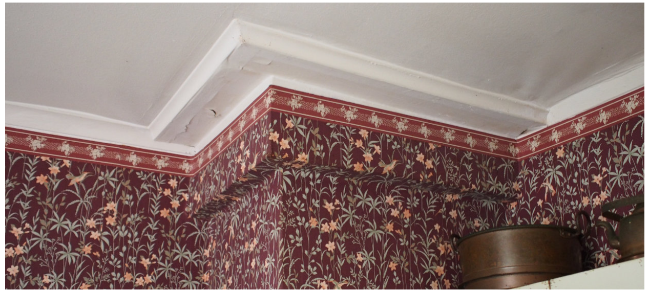
Kuva 89a-b. Purettu tulisijat on tapetoitu huolella. Tapetit ovat vuodelta 1985.
