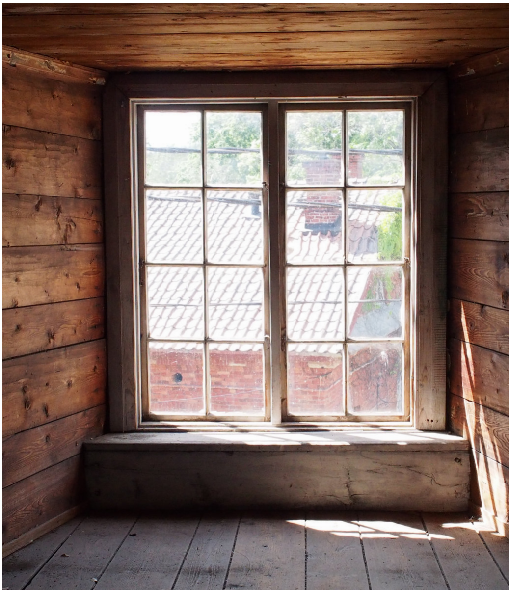
Kuva 61. Ullakon ikkuna länteen. Puitteet ovat kiinni karmeissa sormihaoilla.
