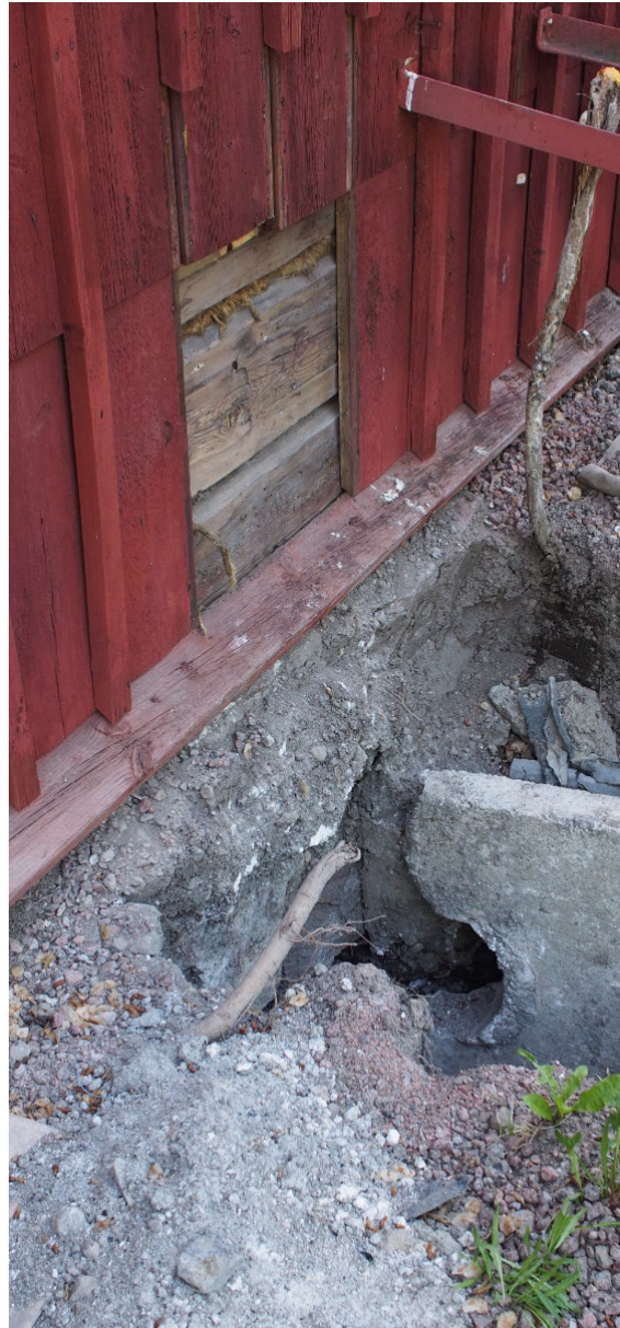
Kuva 40. Julkiverhouk koskettaa maata länsipuolella.
