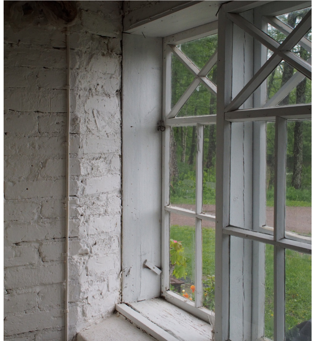
Kuva 63, Keittotilan itäinen ikkuna. Osa sisemmästä puitteesta puuttuu. Myöhemmin rakennettu tiiliseinä väistää kevyesti vanhaa ikkunaa. Puite on koottu kulmaraudoin ja siinä on pieni sormihaka.
