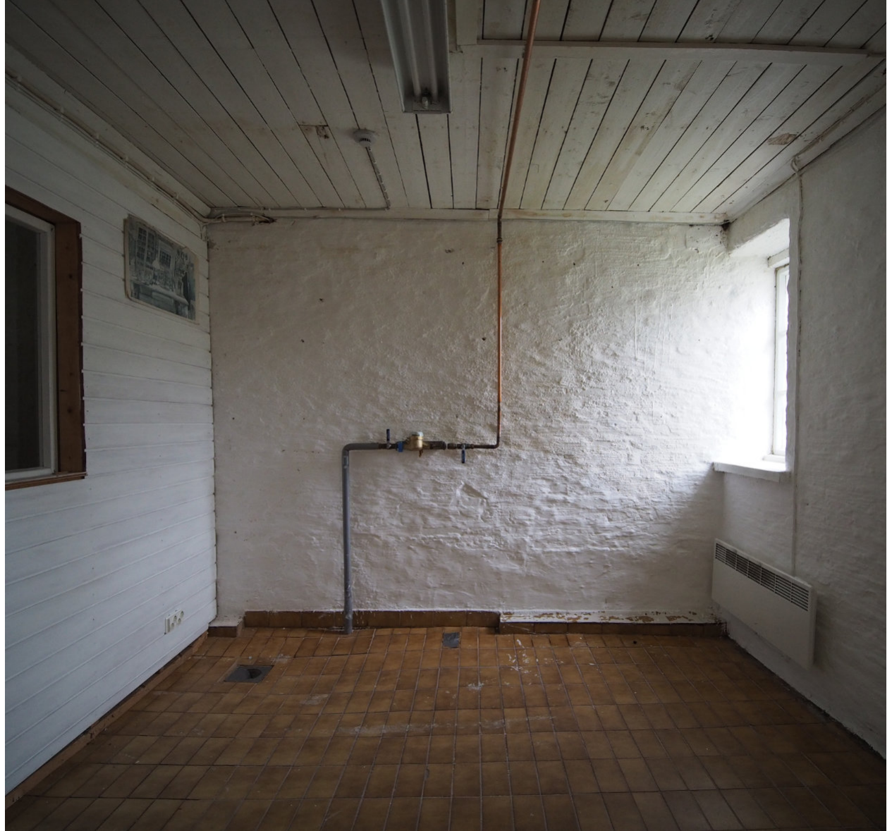
Kuva 77, Myymälän takatila itään. Kuvan vasemmassa reunassa näkyy tilan viemäri. Tilassa on myös patteri. 1900-luvun alussa tehty seinä on rakennettu aivan ikkunaan kiinni.
