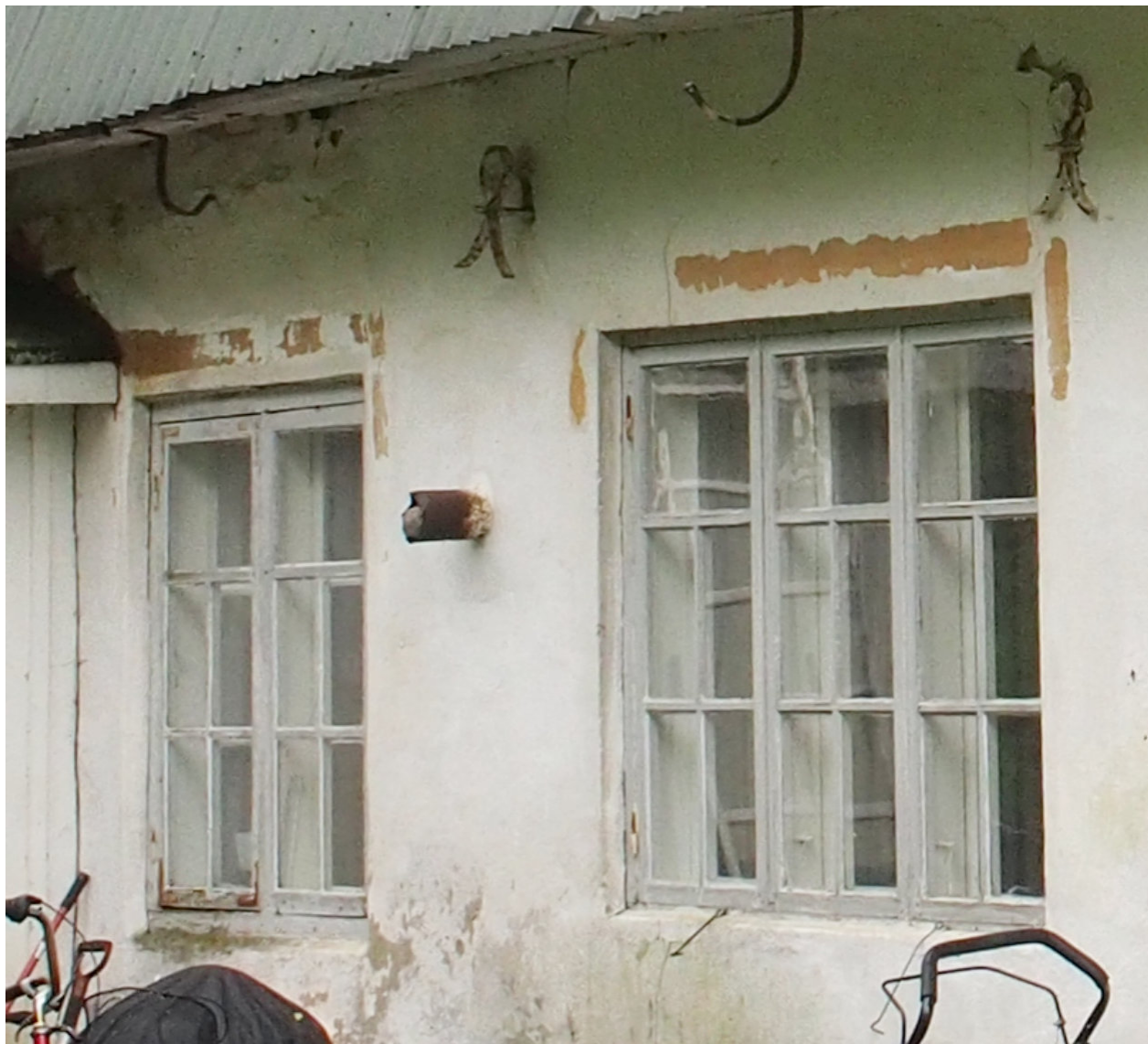
Kuva 64, Pohjoisjulkisivu, entisen karjakeittiön ja puusepänverstaan ikkunat (nykyinen asunto). Ikkunoiden yllä näkyy jäljet vanhoista koristeaiheista. Kolmiruutuisen ikkunan itäisimmässä puitteessa on saranat ja tuulihaat. Kummassakaan ikkunassa ei ole ylimpien ruutujen kolmioaiheita.
