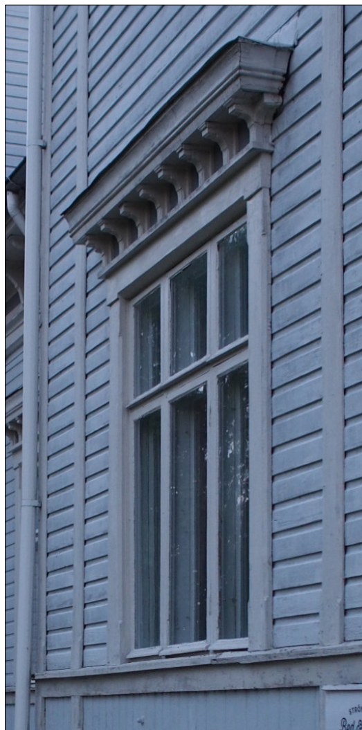
Kuva 57. Eteläjulkisivun itäisin ikkuna edustaa kuusipuitteista ikkunatyyppeä, joita rakennuksessa on vain kaksi. Kaikki ikkunan ruudut aukeavat sisään-ulos.
