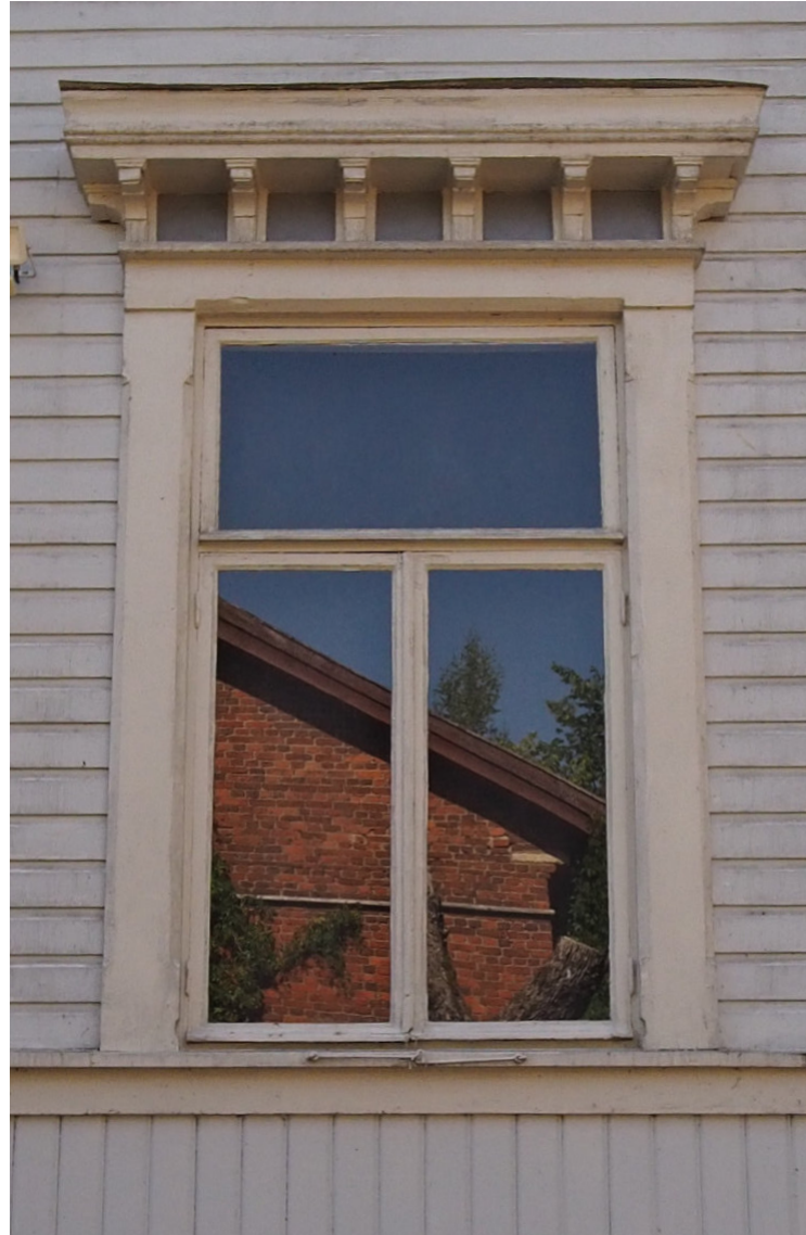
Kuva 62. Pohjoisjulkisivun läntisin ikkuna, joka on muutettu valeikkunaksi viimeistään 1960-luvulla. Ikkunassa on yhä saranat ja helat, mutta sisempi ikkuna vaikuttaa puuttuvan.
