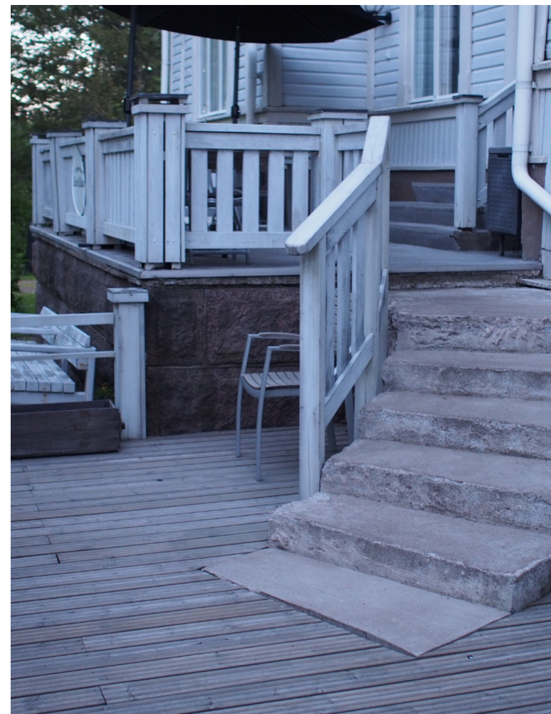
Kuva 76. Terassitasanteelle johtavat betoniset portaat. Ylimmässä portaassa on jäänteitä rakenteen purkamisesta. Uusi vanhan tasanteen päälle valettu betonilaatta erottuu selkeästi muusta rakenteesta.
