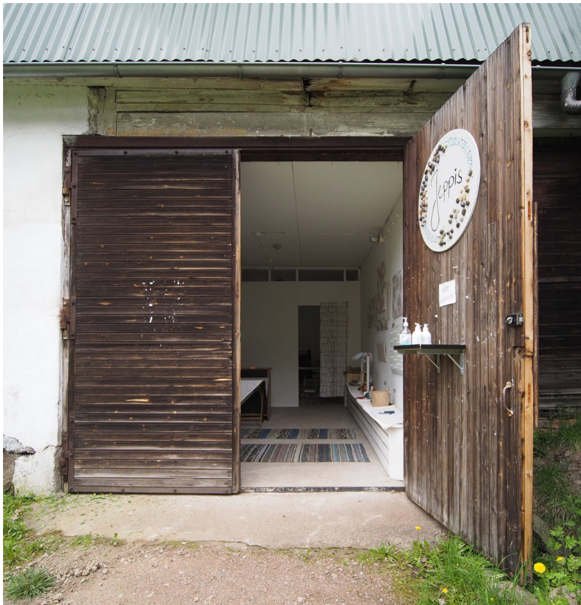
Kuva 56. Pohjoisen 1950-60-luvulla lisätyn autotallin kaksoisovet. Tällä paikalla on ollut ikkuna ja osittain entisen vierastallin pariovet. Oven yllä näkyy hitsirakennetta, josta osa voi liittyä aikaisempiin aukotuksiin (kts kuva 21).
