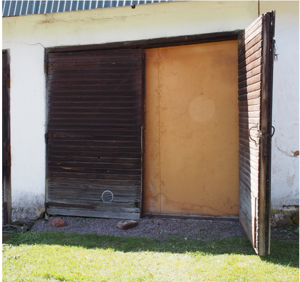
Kuva 52. Entinen eteläinen vaunuvajan ovi. Ovi veisi nykyään entiseen keramiikkapajaan, mutta se on poistettu käytöstä vuonna 1992. Oven opäädystä voi nähdä nykyisen verhouksen alle jäävän vanhemman paneelikerroksen ja lukkomekanismin.
