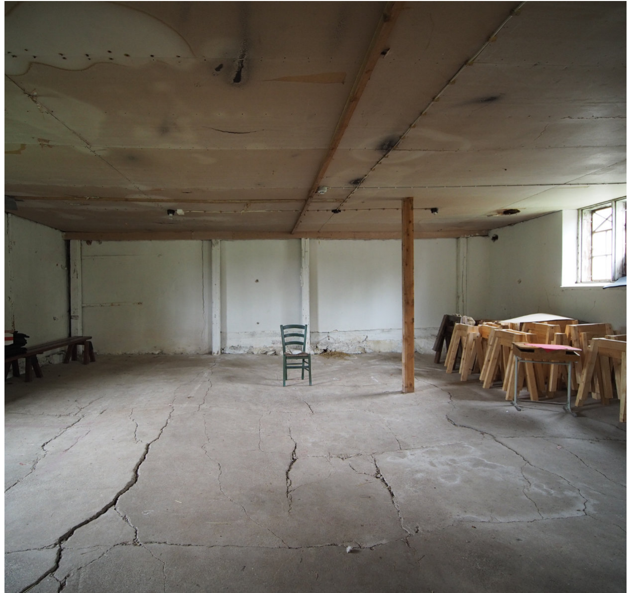
Kuva 69. Varastotila pohjoiseen. Betonilattia on valettu todennäköisesti 1950-luvulla. Päätyseinän hirsistä eniten oikealla oleva noudattaa Lindqvistin 1945 vuoden pitkittäisvasojen mukaista linjaa. Pohjoisseinän länsinurkassa on vetorausosia.
