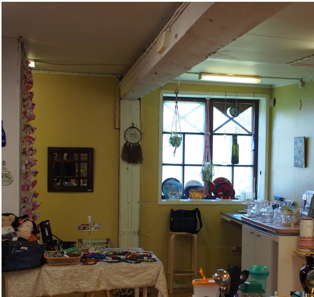
Kuva 78. Entisen keramiikkapajan länsiseinä ja 2000-luvulla lisätty ikkuna. Alakattovasa liittyy todennäköisesti poistettuun väliseinään, koska se ei ole tavallinen osa muuta laipiorakennetta.
