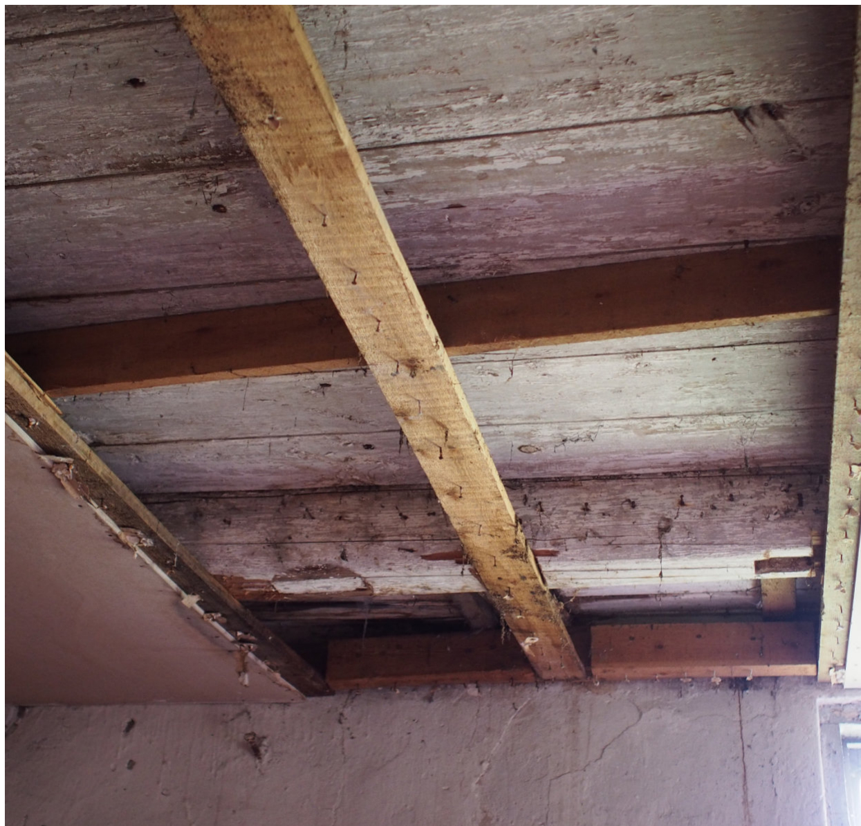
Kuva 39. Pohjoispäädyn tilan laudasta rakennettujen varastohäkkien kohdalta alakattoverhousta on purettu. Kuvassa näkyy yläpuolella olevan etelägallerian lattialaudoitus sekä pitkittäinen alapohjavasa. Rakennetta on lisätuettu laudalla.
