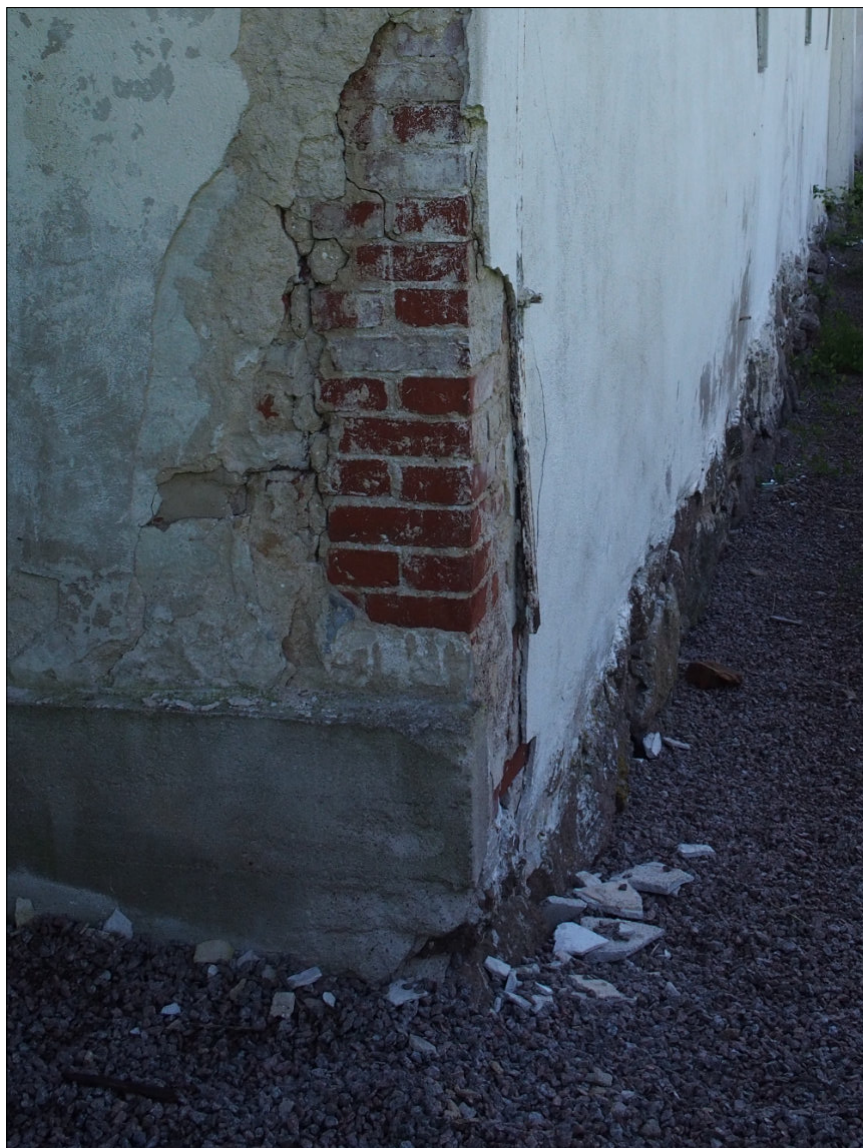
Kuva 48. Lounaiskulma. Betonisokkeli kohtaa luonnonkiviperustuksen länsijulkisivulle siirryttäessä. Länsipuolella rappauksen lomasta pilkottaa teräksinen lista ja pultteja, jotka ulottuvat rakenteen läpi.
