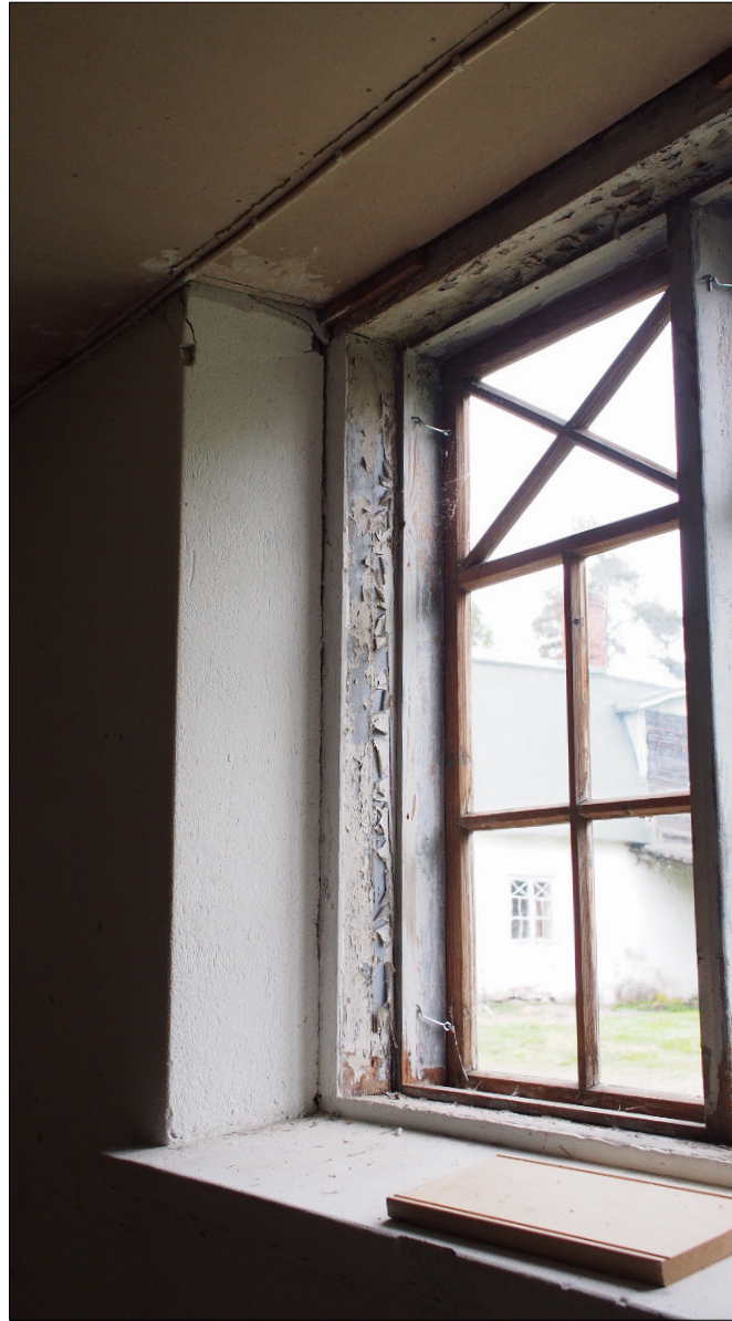
Kuva 61. Itäseinän rakenne on muita seiniä syvämpi ja luo selkeän ikkunalaudan sisäpuolelle. Tästä ikkunasta puuttuu sisätuplat.
