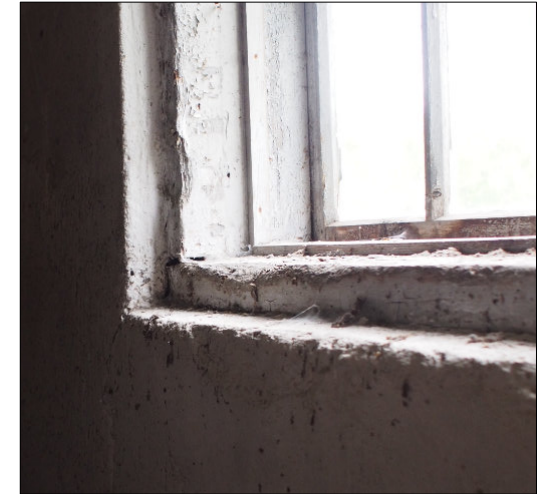
Kuva 62. Länsiseinän rakenne on kapeampi. Tämän ikkunan kohdalla sisärappaus päättyy ennen karmia.
