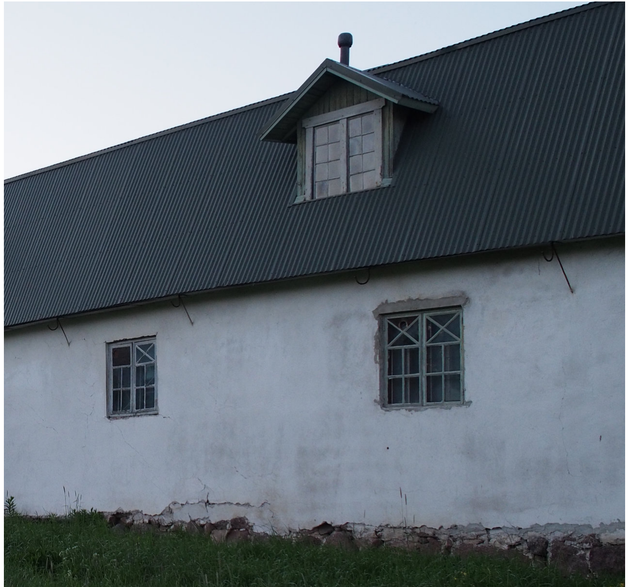
Kuva 59. Oikealla 2000-luvulla lisätty ikkuna, vasemmalla ikkuna 1800-luvulta. Ullakon ikkunalla on vuorilistat.
