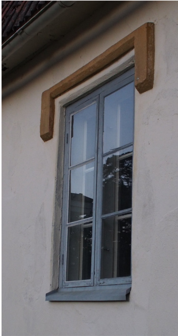
Kuva 16. Savitalon ikkunalla on jäljellä koristeaihe.
