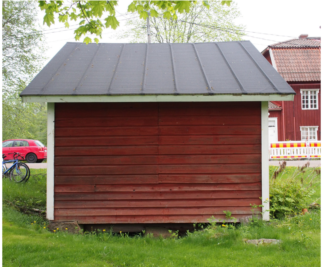
15. Länsijulkisivu. Aitan alle syntyneeseen vajoamasta näkyy perustuskiviä ja alapohjarakennetta. Pontillisessa lautaverhouksessa on jako suurin piirtein keskellä julkisivua. Se saattaa liittyä poistettuun lisäosaan, joka sijaitsi länsijulkisivun pohjoisosassa.
