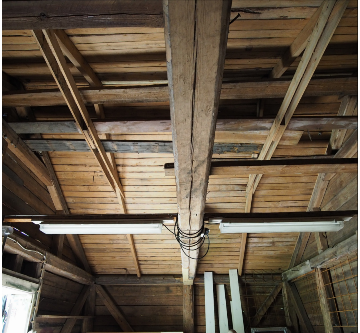
Kuva 18. Aitan kattorakenteita. Vesikatto on muuta rakennetta selkeästi uudempi.
