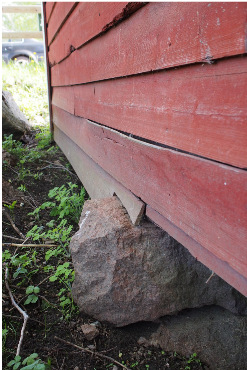
Kuva 19. Pohjoisfasadi. Lautaverhous väistää perustuskiveä.
