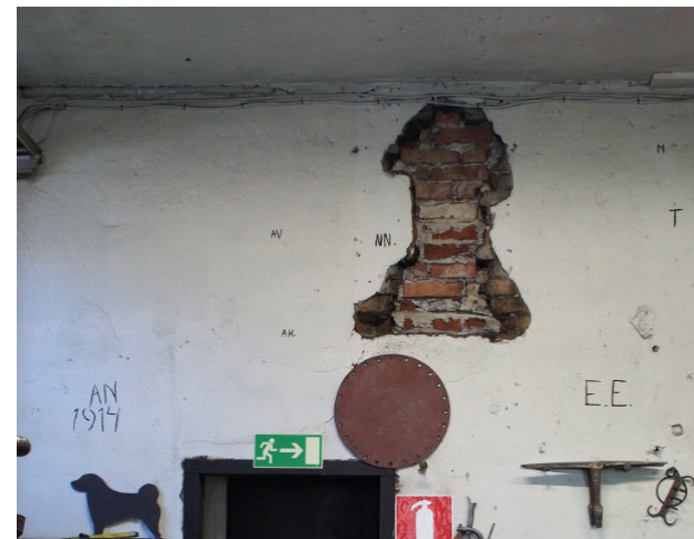
Kuva 38, Korjauspajan seinässä on tiilillä täytetty aukko naulaja nippupajajän välillä. Aukosta on aiemmin kulkenut voimahihna. (kts. Kuva sivulla 23)
