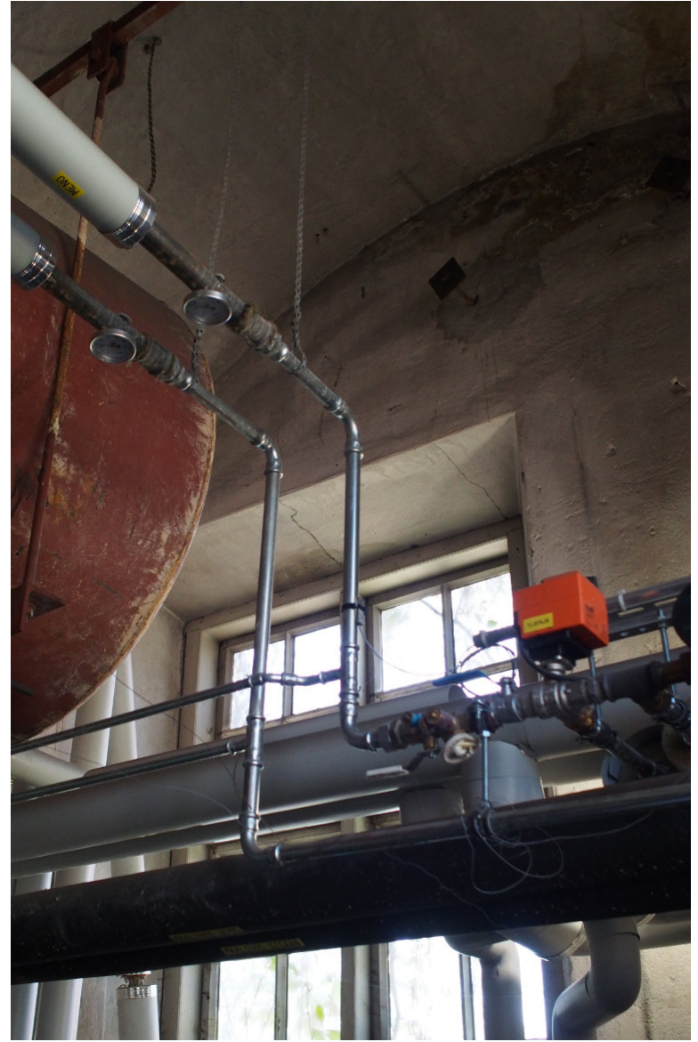
Kuva 55, Kuva entisen smirgelihuoneen, nykyisen varaston länsiseinästä ja holvikatosta. Ahtaassa tilassa risteilee putkia sekä säiliöitä.
