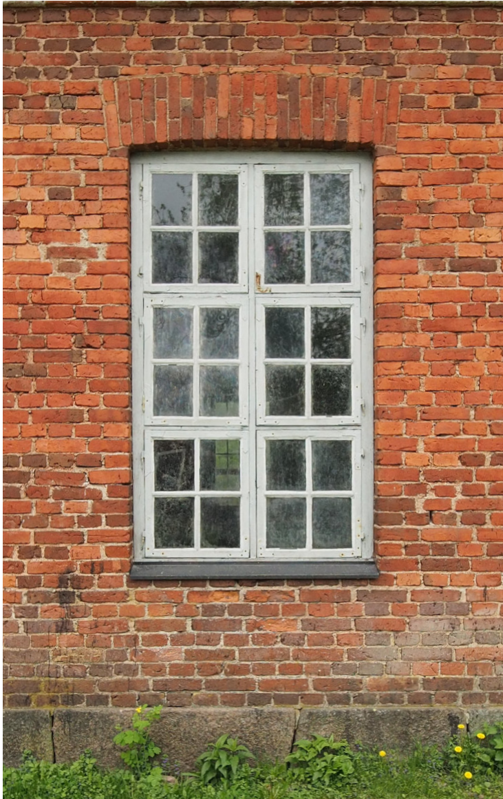
Kuva 57, Itäjulkisivu, pohjoisen sisäänkäynnin pohjoispuolella sijaitseva ikkuna (1857). Ikkunan kevennyskaari on yksi ja puolikiveä.
