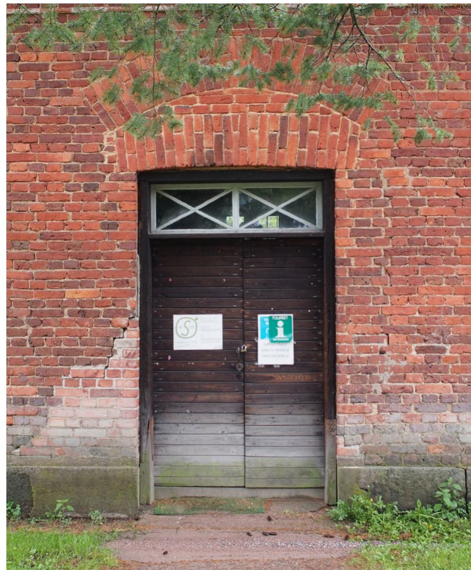
Kuva 68, Itäfasadin pohjoinen ovi, jonka oletetaan sijaitsevan alkuperäisellä paikalla. Oven rakenne sen sijaan on mahdollisesti 1900-luvun alusta. Ovea korjattiin 1990-luvulla perustuksista johtuvan romahduksen vuoksi. Oven vasemmalla puolella näkyvän korjauksen ajoitus ei selvinnyt.
