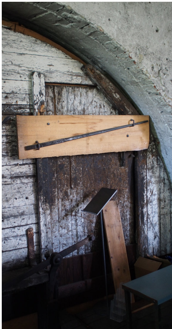
Kuva 64, Kaariaukon lautaovessa on työn aiheuttamaa kulumaa. Naulapajan ja nippuvapajan välisestä lattiakorkoerosta johtuen, tämän oven edessä on ollut yksi porras nippupajaan laskeuduttaessa.
