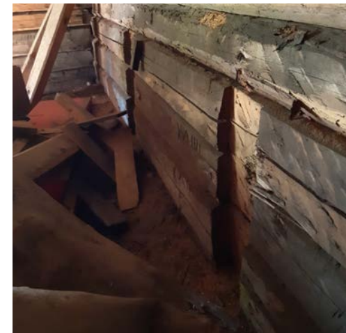
Kuva 28. Lovet ullakon seinässä.
