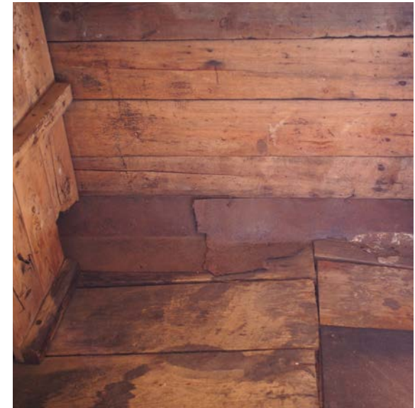
Kuva 83. Tilassa kiertää pahasti ruostunut metallinen lista.
