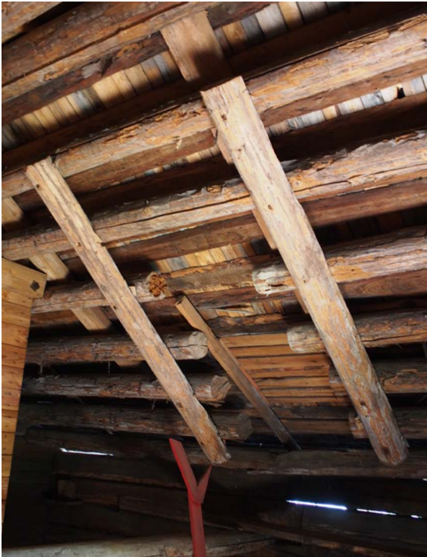
Kuva 74. Vanha piipun poistaminen on jättänyt etelälappeen hirsiiin aukon. Lappeen alin hisi on lahonnut melkein halki.
