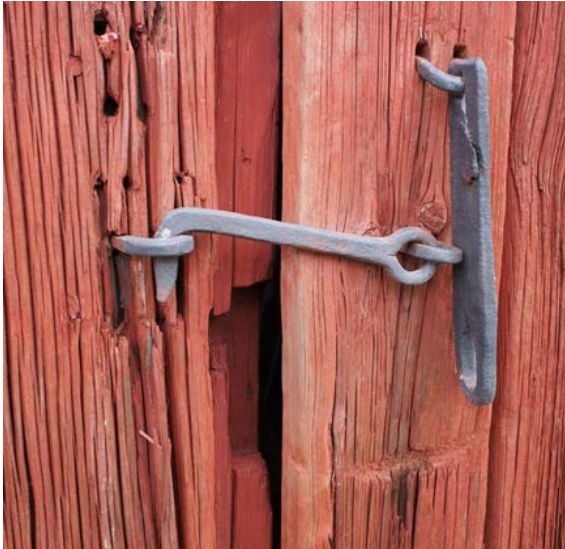
Kuva 67 (yllä). Välikön oven sydänmenpääsarana. Kuva 68 (alla.) Nykyinen haka ja vanhan säpin hela.
