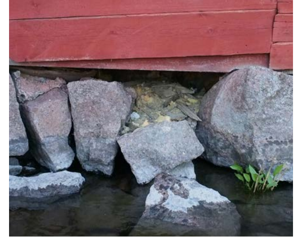
Kuva 34. Makasiinin alla näkyy puun kappaleita ja eristevillaa.
