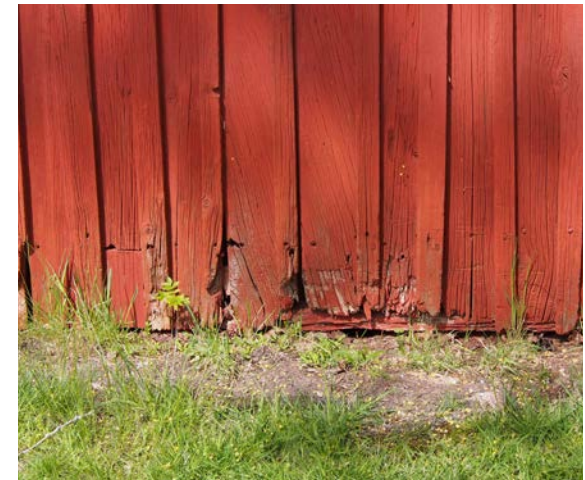
Kuva 35. Julkisivuverhous koskettaa maata eteläisivulla.
