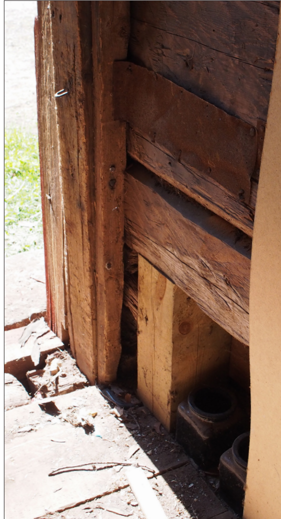
Kuva 40. Keskimmäisen hirsikehikon seinän alaosa puuttuu hirsä. Ne on korvattu puisilla pystypalkeilla. Palkkien alla on alaohjauspuu.
