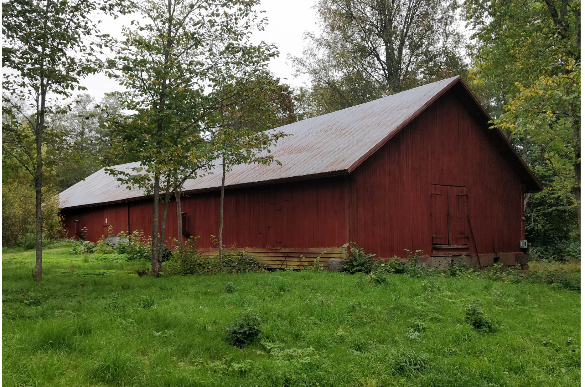
Kuva 19. Rakennus kuvattuna luoteesta. Pärekatteen päälle asennettu aaltopeltikate on osin ruostunut.
