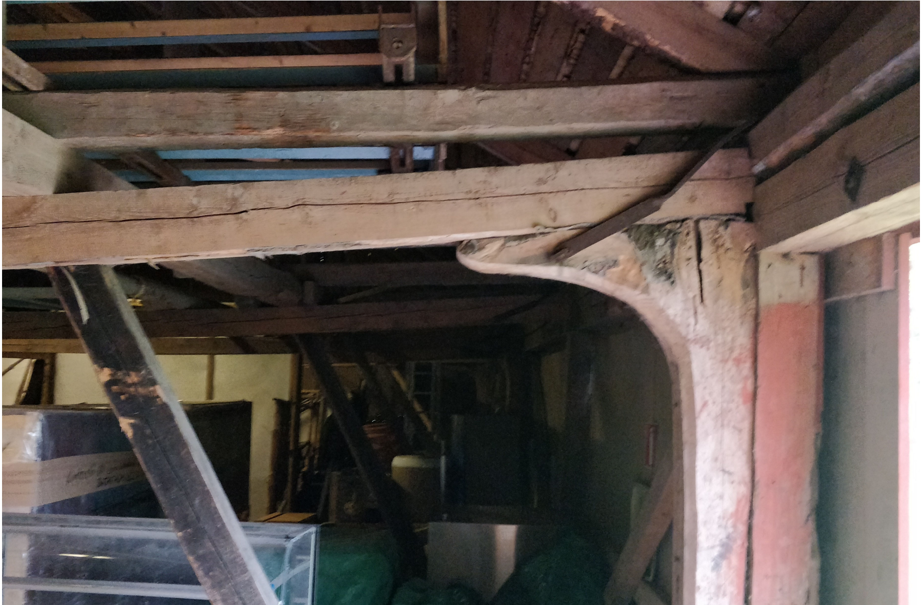
Kuva 45. Seinärakenteen ja palkin liitos liukuoven vieressä. Juuripuu on osin hajennut palkin painuman johdosta. Liitosta on rakennuksessa kauttaaltaan vahvistettu kierretyllä lattateräksellä.
