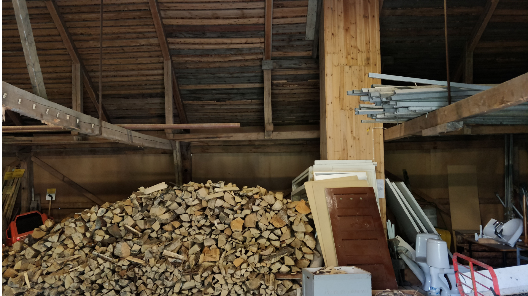
Kuva 42. Puinen kellaritilaa tuulettava ja tavarahissinä toiminut hormi näkyy oikealla. Sen vieressä kulkevan palkin alle on lisätty puupalanen vetotangon kohdalle. Poikittaispalkit ovat keskenään eri värisiä ja siis mahdollisesti eri ikäisiä. Erillisen osan vaihtaminen on kuitenkin haasteellista. Todennäköisempää on, että puutarpeisto on jo varastointivaiheessa ollut eri laatuista.
