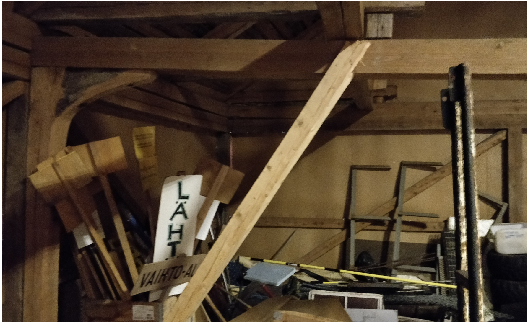
Kuva 44. Molemmissa päädyissä reunimmaisen palkin toinen vinotuki, "kontti" on uusittu. Seinärungon ja vaakapalkin liitos on rakennettu joka toisen palkin kohdalla juuripilarilla. Pystypilari on siis veistetty aivan puun tyvestä.
