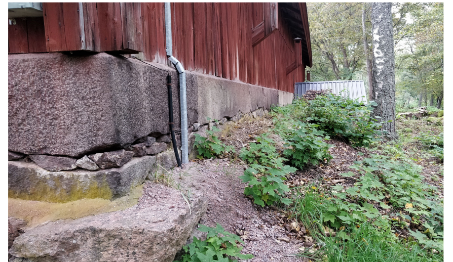
Kuva 18. Varaston perustus on erityisen huolella tehtyä johtuen sen historiasta. Ylimmät kivet ovat tasaiseksi hakattu ja yläpinnaltaan viistetyt. Julkisivusta ulos vinosti työntyvät puiset hormit poistavat ilmaa kellarista.
