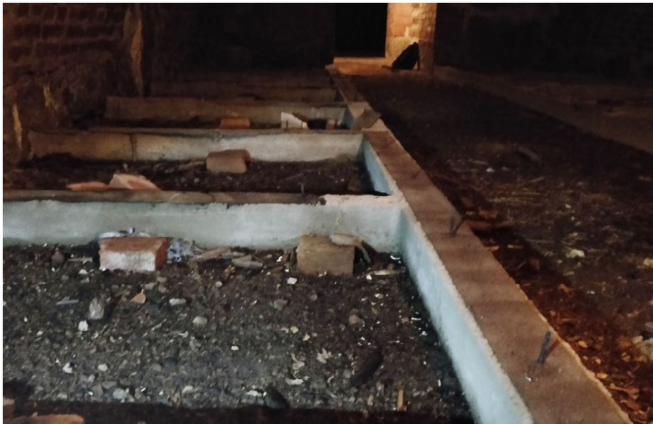
Kuva 39. Toisen holvin lattiaan on tehty perustukset ja teräksiset tartunnat vuokrattavia kylmäsäilytyseriöitä varten.
