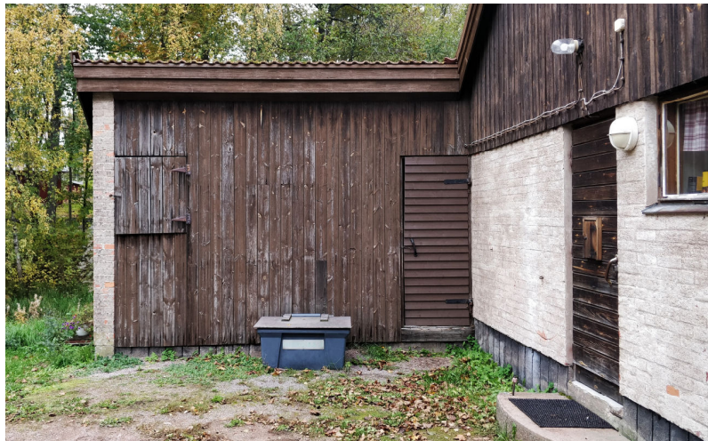
Kuva 23. Rakennuksen länsipääty oikealla. Puuvaraston ovi on uusittu n. 10 vuotta sitten.
