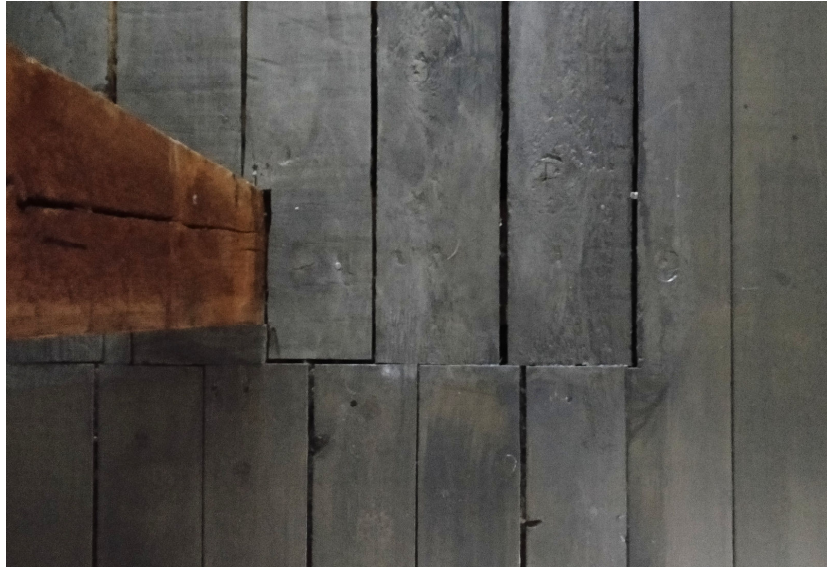
Kuva 47. Lattialaudoituksessa on jatkos, joka kertoo että laipion ja lämpimän tilan seinä on ollut aluksi eri kohdassa.
