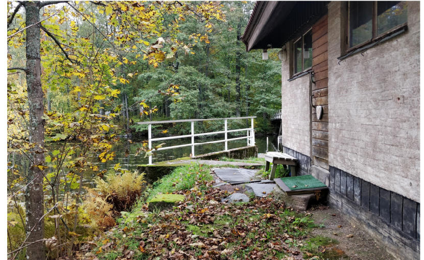
Kuva 29. Pohjoisjulkisin vilvoittelupaikka, oven edessä näkyy sammaloitunut porrasaskelma. Betoniporaat ovat johtaneet veteen. Nykyisellään kasvusto on vallannut kulkuväylän. Taaempänä näky betonirakenteita ja kaide. Paikalla on ollut alun perin laitur.
