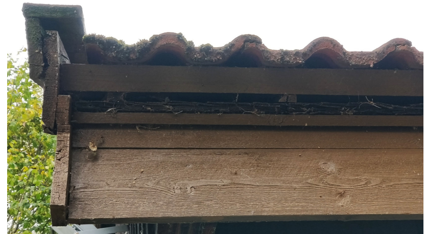
Kuva 30. Betonitiilikatteen alla näkyy räystäällä vanha pärekate. Räystään korkeus on kasvanut ylimmän räystäslaudan verran muutoksen myötä.
