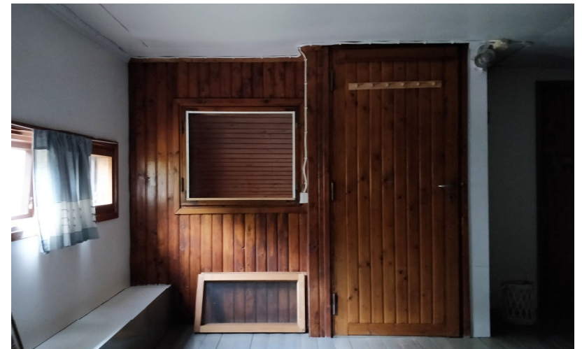
Kuva 42.. Kuva ullakolta portaaseen johtavaa ovea kohti, sen vasemmalla puolella on sisäikkuna. Seinä lienee tehty heti rakennusvaiheessa estäen kylmän ilman pääsyn alakertaan.
