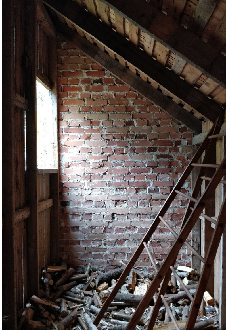
Kuva 28. Puuvaraston sisätilaa. Päädyssä näkyy slammattu seinä sisäpuolelta. Muuraus on tehty varveittain pitkä tai lyhyt sivunäkyvillä. Katossa erottuu vanha pärekate.
