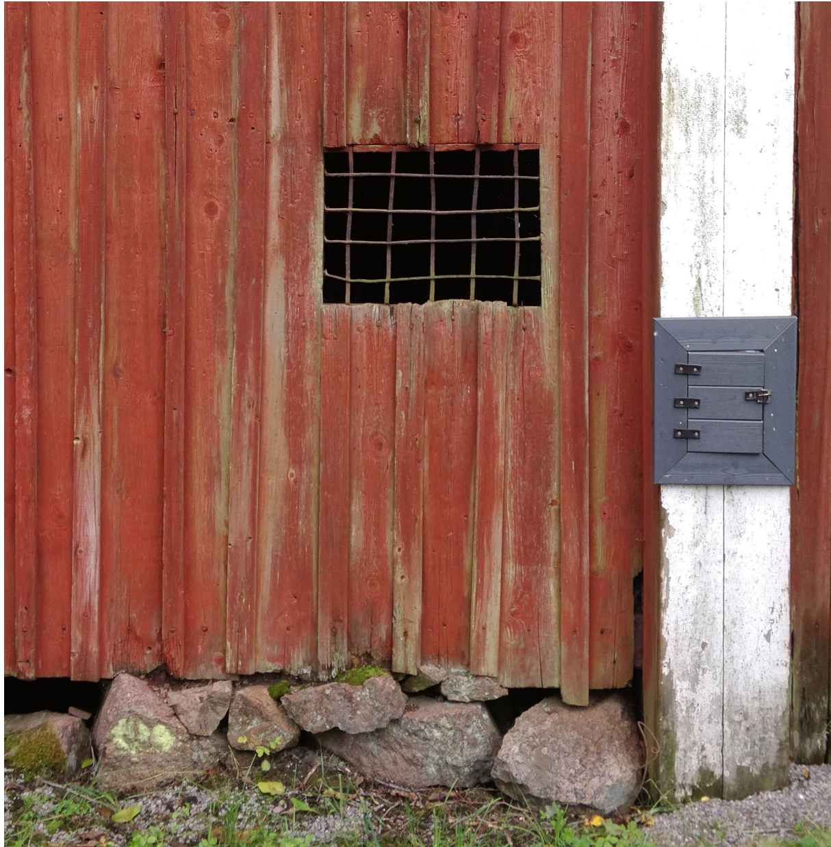
Kuva 27. Pohjoisjulkisivun "sellin" kalterilla peitetty aukko. Laudoituksen alaosan muotoilu kertoo siitä, että perustuskivet ovat liikkuneet ja painuneet ajan myötä.
