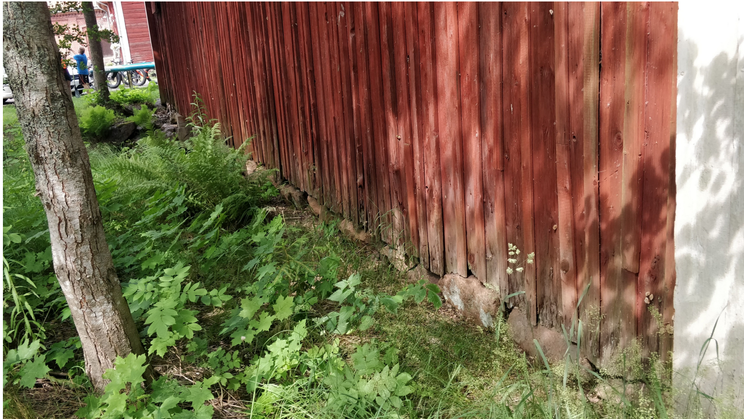
Kuva 18. Verkhusin länsijulkisivua. Perustuskivet ovat monin paikoin painuneita eivätkä muodosta tasaista perustustasoa. Julkisivu on korjaustoimenpiteistä huolimatta keskeltä selvästi reunojaan alempana.
