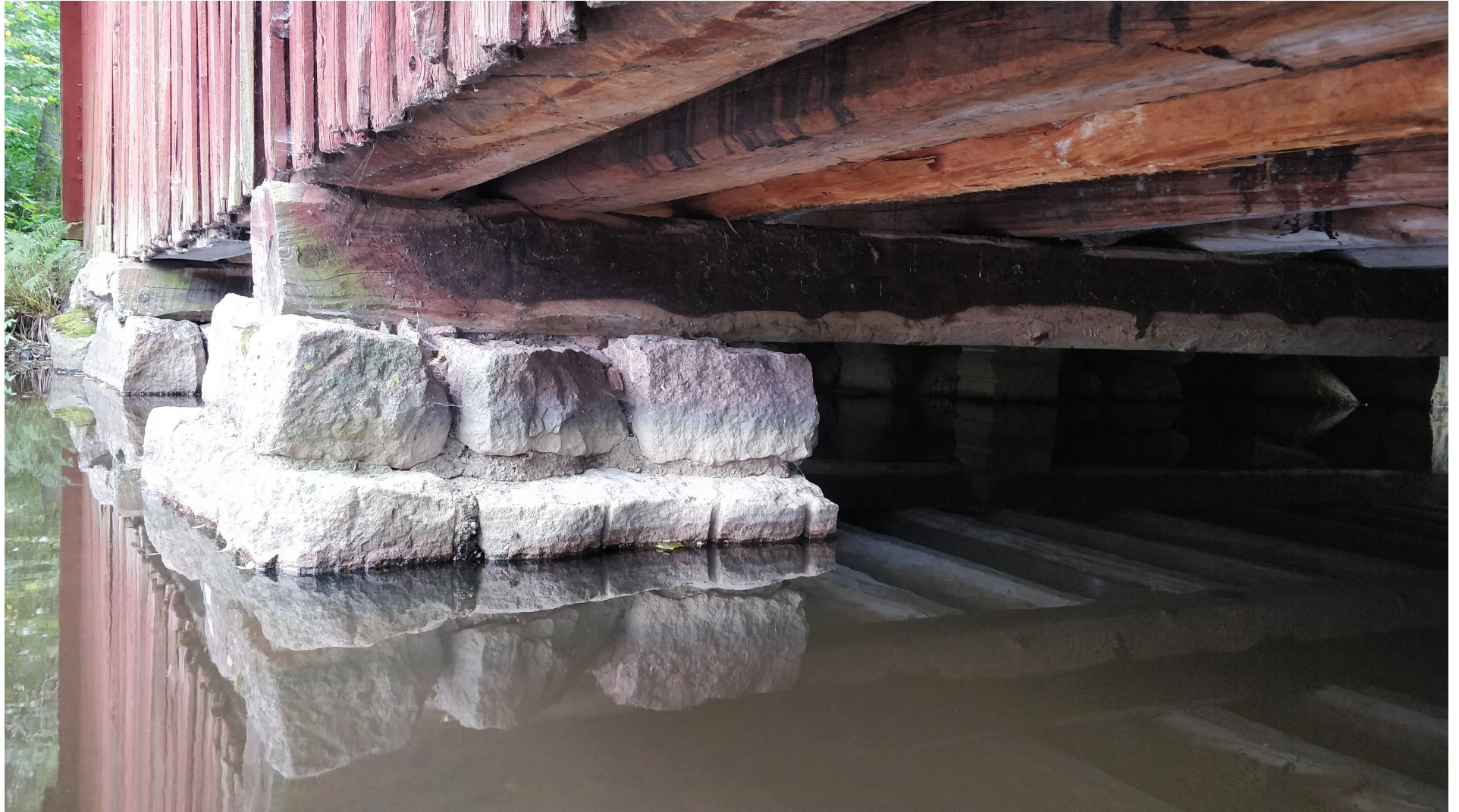
Kuva 20. Vesiuoma vastakkaiselta puolelta nähtynä. Primääripalkit lepäävät uudelleen rakennetun betoni- ja kiviperustuksen päällä, ne kannattavat tiheään ladottua rakennuksen suuntaista sekundääripalkitusta. Puupalkit on tervattu. Vanha julkisivulaudoitus on onnistuttu säästämään korjaustöiden yhteydessä.
