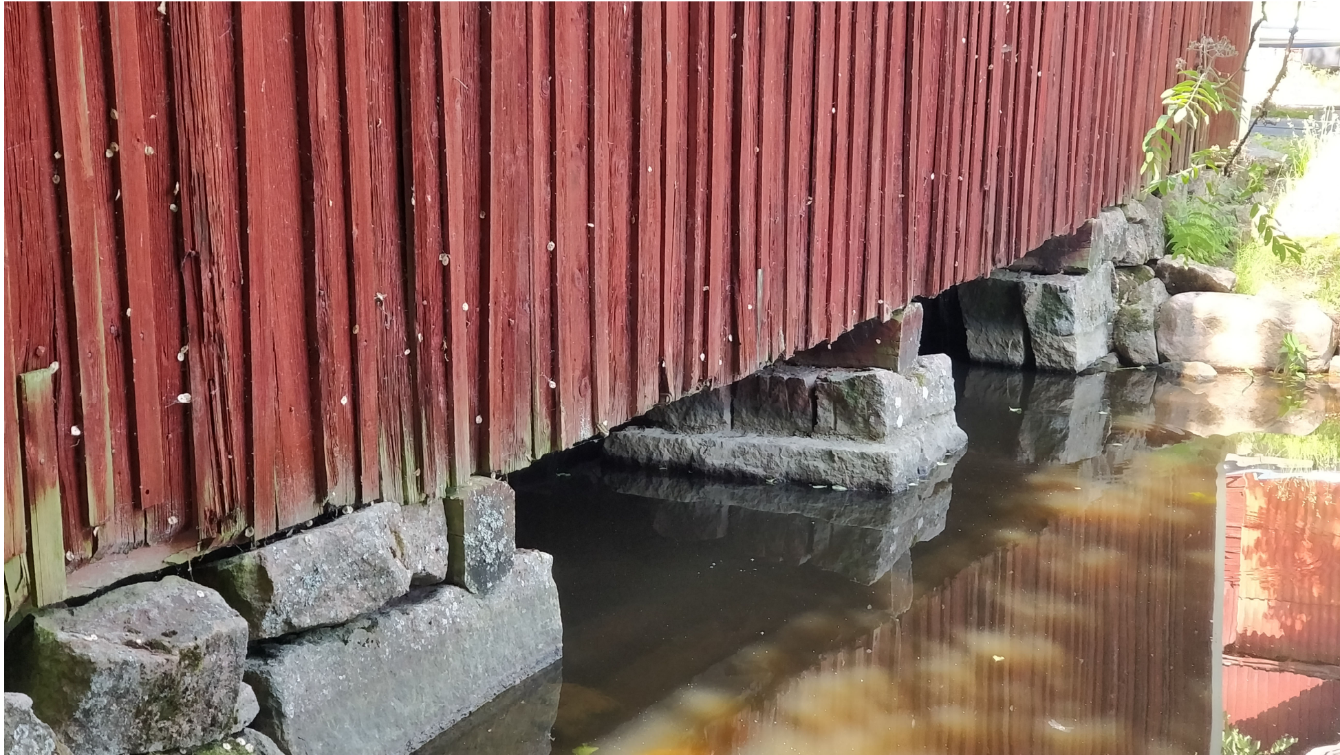
Kuva 19. Vesiuoman reunoilla ja keskellä on kiviladonta, jonka päällä on poikittain hirsi kannattamassa alapohjaa. Nämä rakenteet uusittiin vuoden 1997 kunnostustöissä. Kolme poikittain olevaa kookasta hirttä muodostavat vesiuoman kohdalla primääripalkiston.
