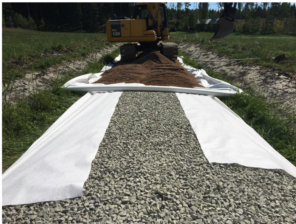
Bild 2. Furunäs-Edö väglag sommaren 2022; Förbättring av vägens struktur och dränering, höjning av väg som utsätts för översvämning vid högt havsvattenstånd. Ett ca 50 cm tjockt lager skumglas bredds ut och "paketeras in" i fiberduk, sedan körs det på ca 20-30 cm grus. (bild Kindstedt S.)
