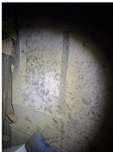
Kuva 4-2. Kuvia lepakoiden jätöksistä seinämässä rakennuksesta 2.
