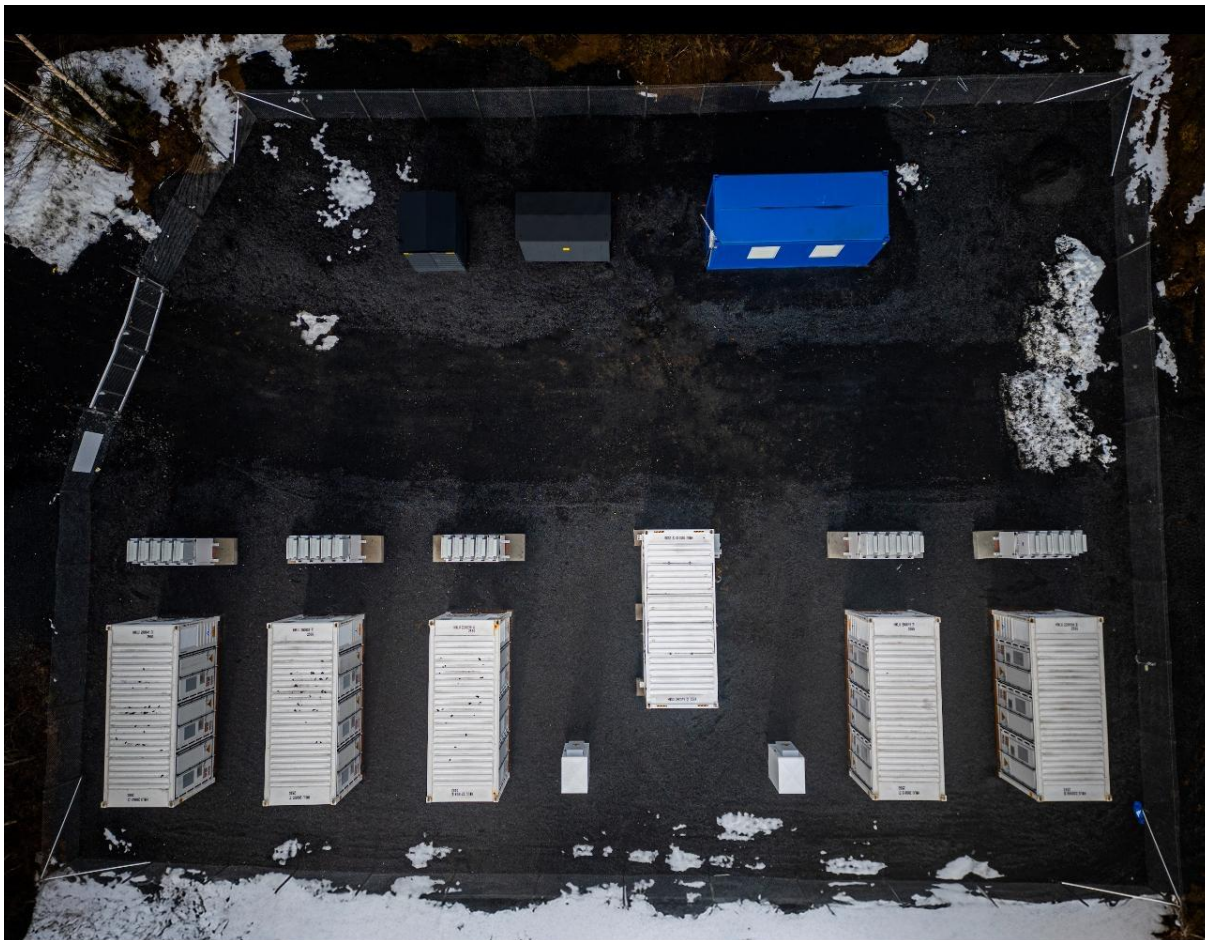
Referenssikuva energiavarastoista. (Kuvan lähde: Huawei)
